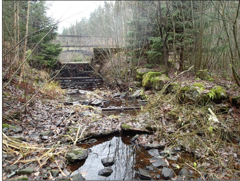
Kivin pengerrettyä uomaa Björkenheimin sillan pohjoispuolella. Kuvan taustalla näkyy uomassa oleva betonipato sekä Björkenheimin silta. Etelään.
