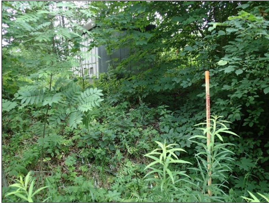
Maakaapelilinjaa pappilan pihamaalla. Taustalla muuntaja. Kaakkoon.
