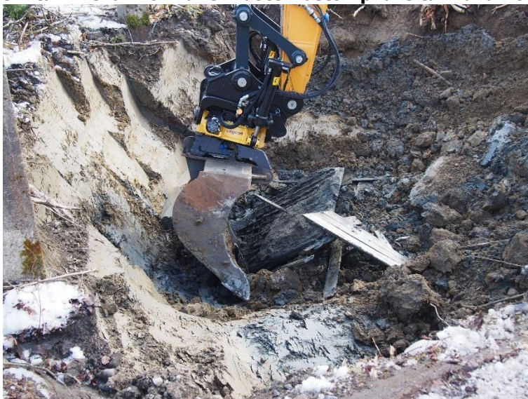
Kuva 2. Betonipilarin alapuolella oli n. 1,2 m x 1,2 m kokoinen raudoitettu ja valettu betoniantura. Maakerroksia oli muokattu noin 2 – 3 metrin syvyyteen nykyisestä maanpinnasta. 13.3.2017.
