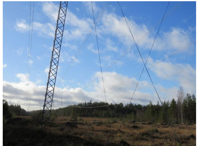
Kuva 22. Voimalinja Hautanevan luoteispuolella, kuvattu lounaaseen.
