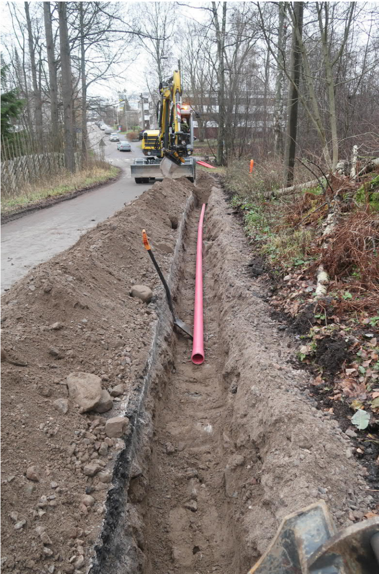
Kuva 14. Uutta putkea peitetään jo sitä mukaa, kun asennus edistyy. Näkymässä Vaskiniementietä itään päin. Kuvaussuunta E. Kuva Heini Hämäläinen/HKM 20.11.2019.
