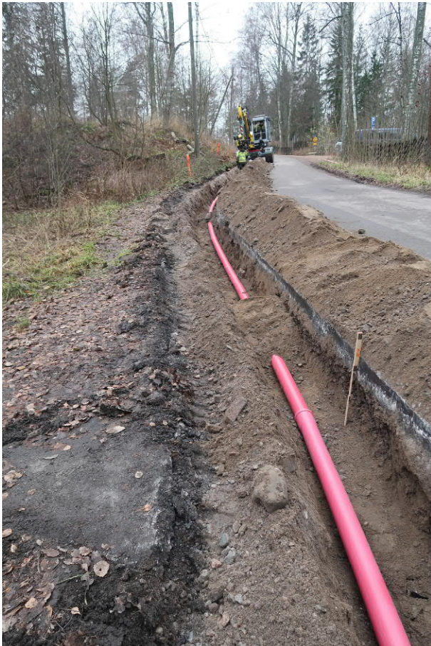
Kuva 9. Kuten edellä. Taittomitta kohdassa HP1. Kuvaussuunta W. Kuva Heini Hämäläinen/HKM 20.11.2019.
