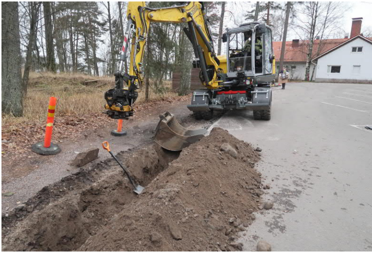
Kuva 35. Toisen valvontapäivän loppuksi rakentajat vielä asentavat putken paikoilleen ja täyttävät kaivannon. Kuvaussuunta W. Kuva Heini Hämäläinen/HKM 21.11.2019.
