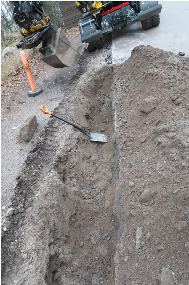
Kuva 34. Kaivannon valvottu osuus loppuu lähelle pihan roskakatosta. Kuvaussuunta W. Kuva Heini Hämäläinen/HKM 21.11.2019.
