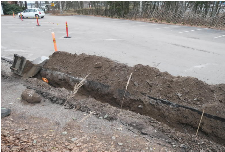
Kuva 37. Valvotun kaivannon loppupäätä luoteeseen. Taittomitta kaivannossa HP8:n kohdalla. Kuvaussuunta NW. Kuva Heini Hämäläinen/HKM 21.11.2019.
