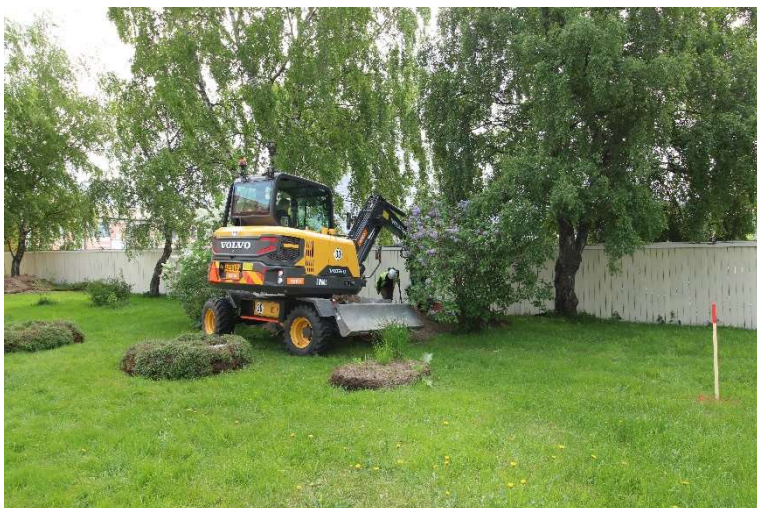
AKDG5598:123. Koekaivettavaa aluetta. Heli Lehto valvoo kaivinkonekaivua. Kuvattu luoteesta. Kuvaaja Tuija Väisänen.
