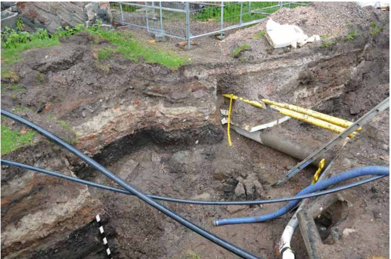
MuTu120015Dg_2. Yleiskuva kaivannon keskiosaan. Länsiprofiili, profiilit 1-3 ja poikittaisten putkien takana profiili 4. Kaakosta, M. Helamaa, 11.5.2020.
