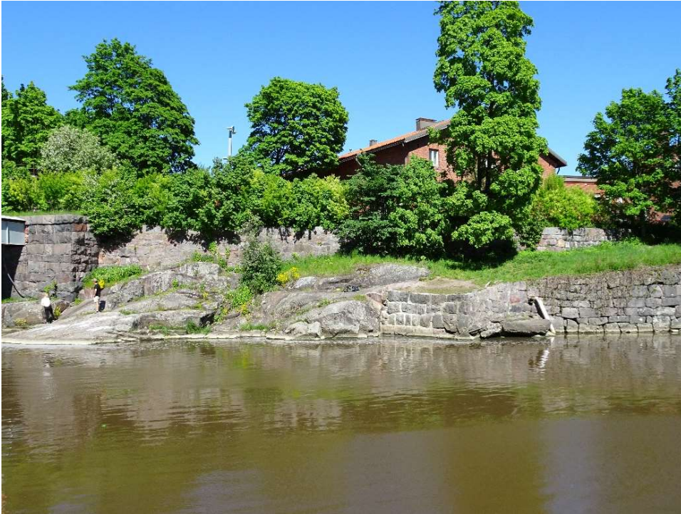
Kuva 12. Kohde 6: betonitaso kosken länsihaaran suulla, Kuninkaankartanonsaaren rantamuurin kulmauksessa. Rakenne saattaa liittyä joko tukiuittoon tai vesilaitoksen toimintaan. Valokuva-aineisto ajoittaa rakenteen 1930-luvulle tai varhaisemmaksi. Kuva: E. Vakkari 30.5.2020.
