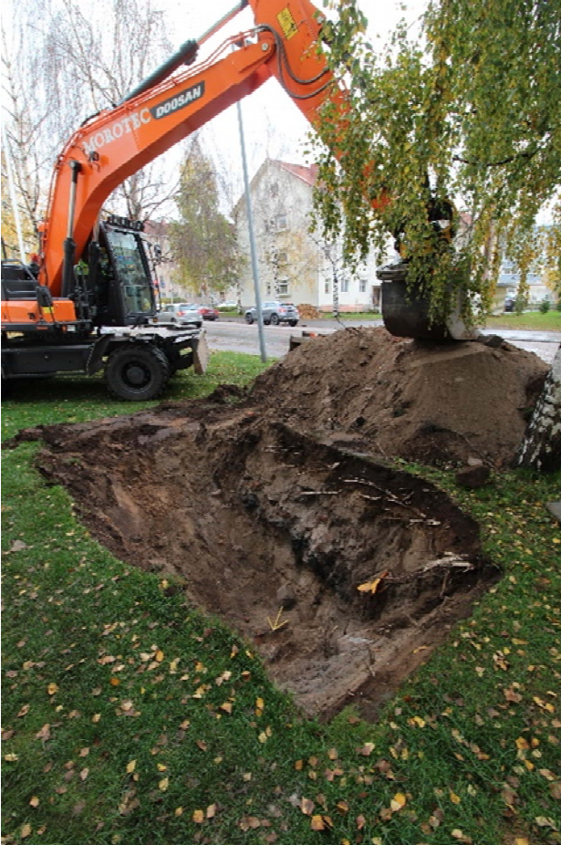
AKDG6554:20. Yleiskuva koekuopasta 2 ja sen sijainnista Kajaaninkadun varrella. Pohjoisesta. Kuva: Matleena Riutankoski.
