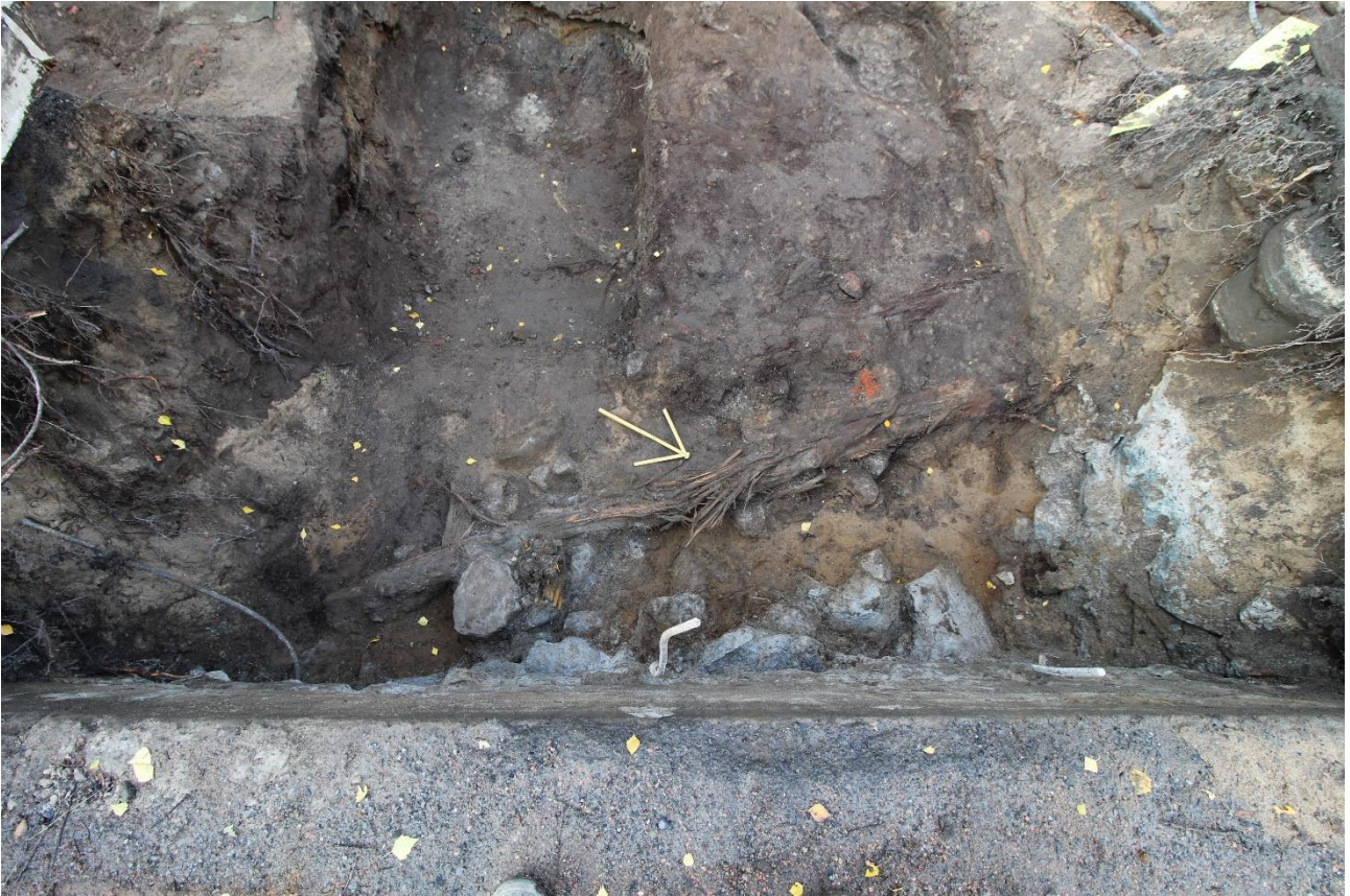
AKDG6460:179. Sillan lounaispäädyn betoniantura on poistettu. Näkyvissä koekaivausten koekuoppa 8 sekä sillan perustukseen liittyvät pystyhirret R244AB ja keltainen hiekka Y245. Näkyvissä myös hirret R219. Koillisesta. Kuva: Matleena Riutankoski
