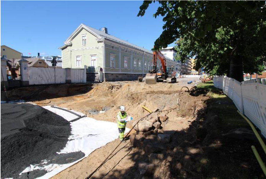
AKDG6315:158. Sepänkadun ja Albertinkadun välinen valvonta-alue. Terhi Taipaleenmäki dokumentoi kivijalkaa R45. Kuvassa oleva vihreä rakennus on ns. Snellmanin talo. Etelästä. Kuva: Matleena Riutankoski
