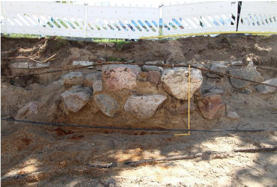
AKDG6315:152. Etualalla kivijalka R45, oikealla taustalla kivijalkaa R42. Luoteesta. Kuva: Matleena Riutankoski
