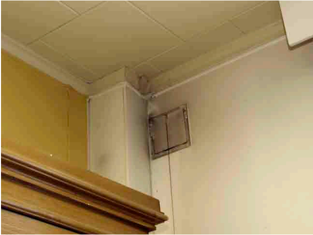
Tuloilmaventtiili luokan ulkoseinässä.
