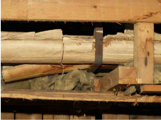
1950-luvun pahvieristeillä verhottuja lämmitysputkistoja kellarin katossa.
