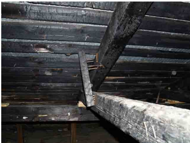
Vuoden 1936 tulipalossa hiiltyneitä vesikattorakenteita.
