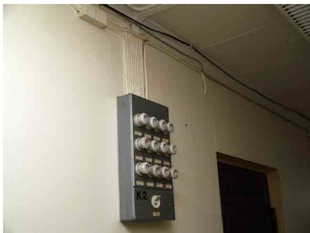
Yläkerran käytävän seinällä oleva ryhmäkeskus..
