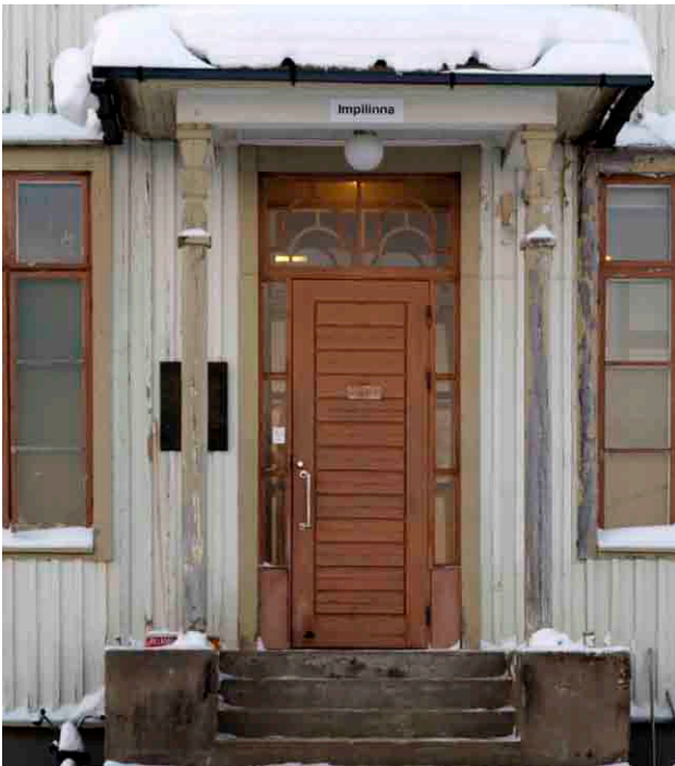
Impilinnan pääovi katoksineen nykyisin. Ovi uusittiin ja muutettiin yksilehtiseksi 1980-luvun korjauksessa. Karmit ja yläikkuna ovat alkuperäisiä.
