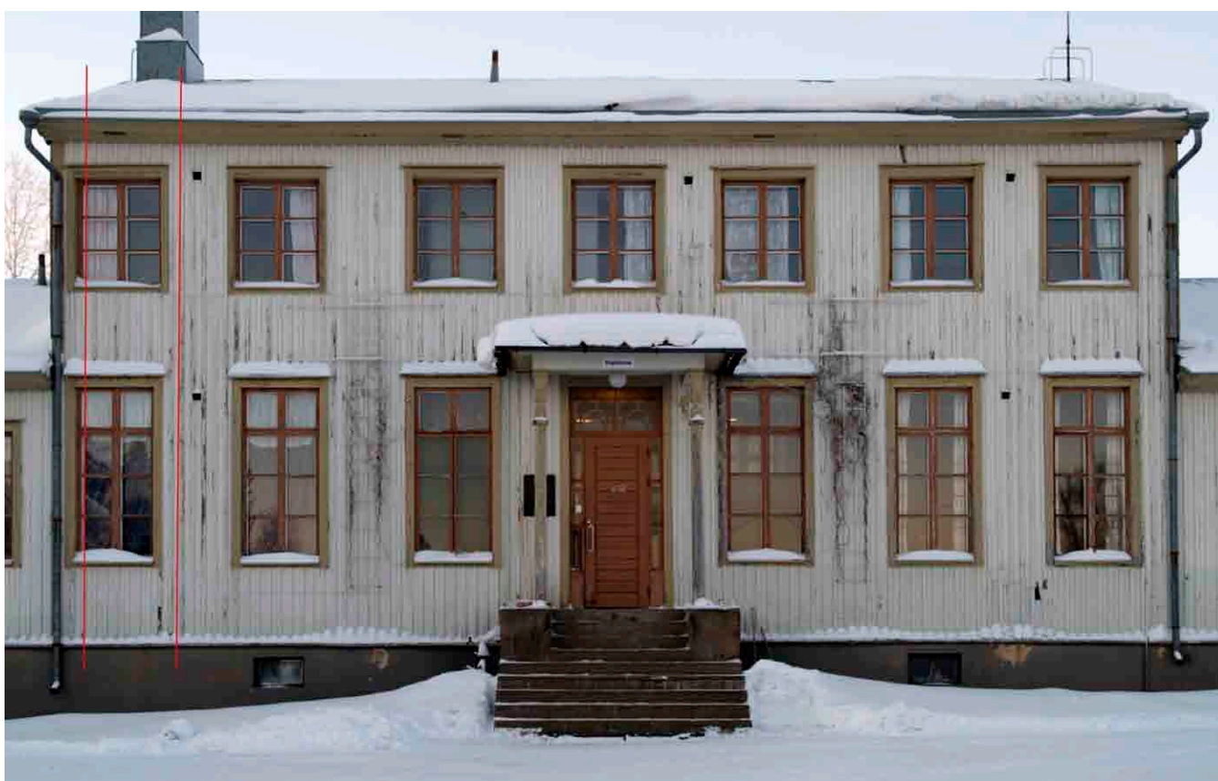
Pääjulkivussa näkyvä, pieni symmetriaa rikkova rakennusvirhe: vasemmanpuoleiset ikkunat ovat liian lähellä 2. kerroksen nurkkaa (symmetrisesti oikea sijainti merkitty punaisilla viivoilla kuvaan; kts. lähemmin teksti).
