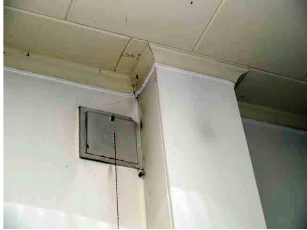
Luokan ulkoseinällä ikkunavälissä oleva pilasteri on verhottu lastulevyllä. Vieressä IV-venttiili.
