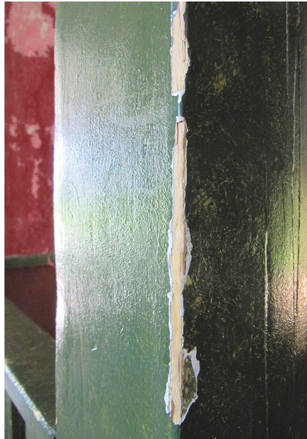
Kuva 29. Kolhuja pylvään kulmassa
