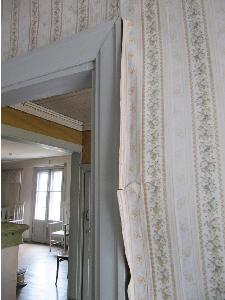
Kuva 40. Oviaukon vieressä pahvi oli irti seinästä
