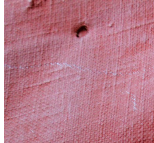
Kuva 13. Naulan aiheuttama kuoppa seinäpinnassa
