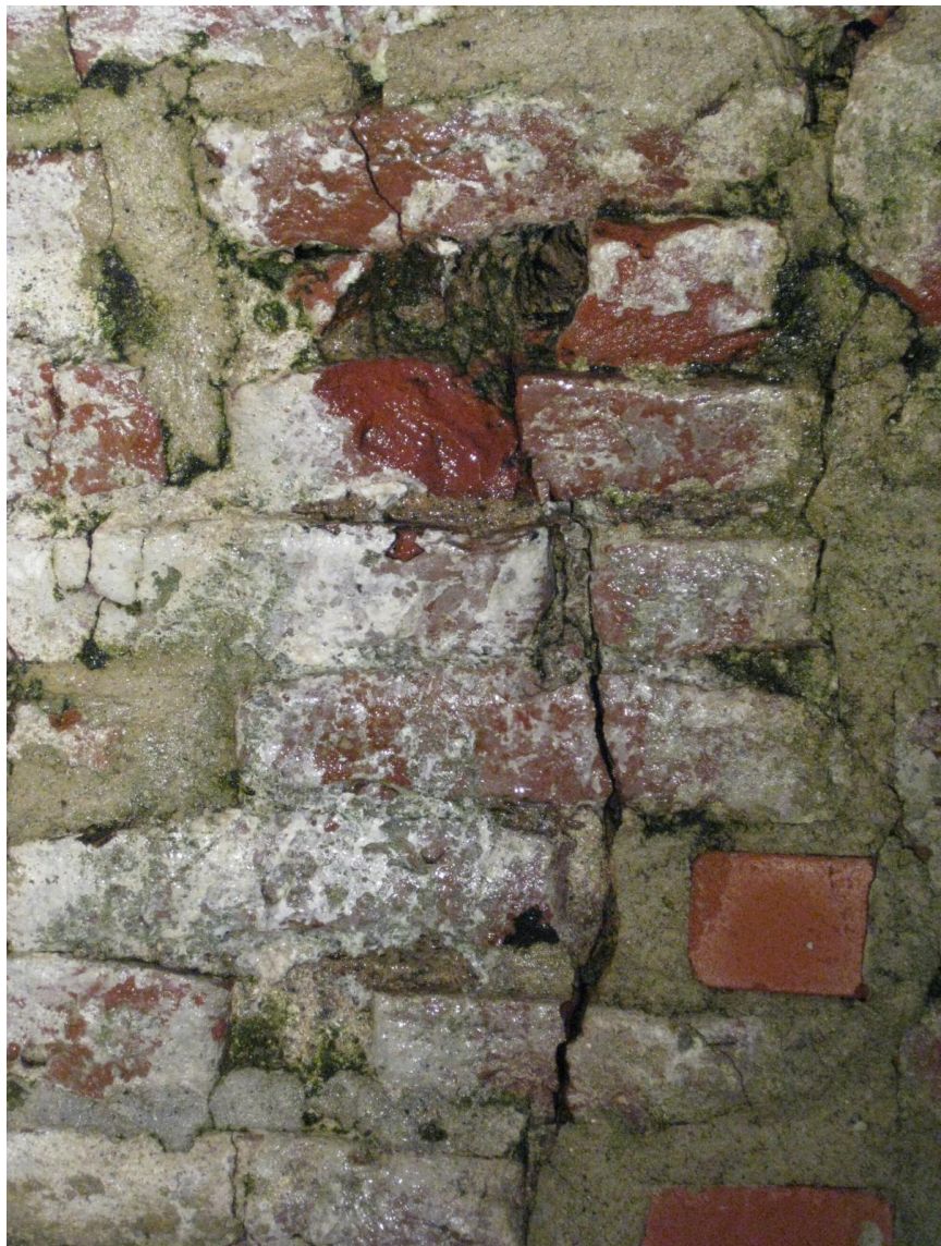
Kuva 5. Jatkuva veden valuminen on aiheuttanut vaurioita seinään (L-105)
