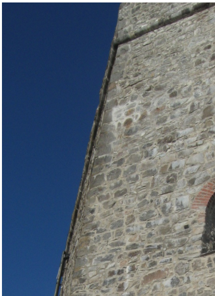
KUVA 9. Vaalea Fescon-alue erottuu muusta seinäpinnasta.
