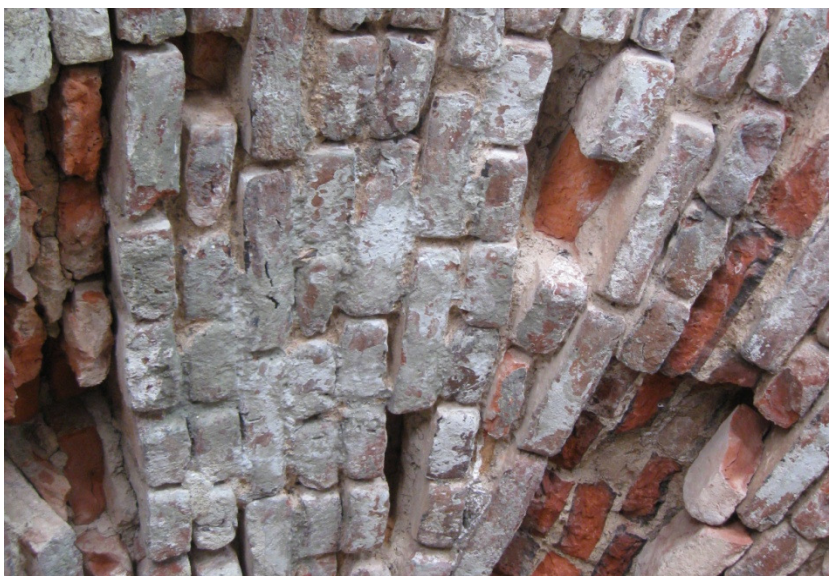
KUVA 6. Useat tiilet ovat irtonaisia ja huonossa kunnossa.
