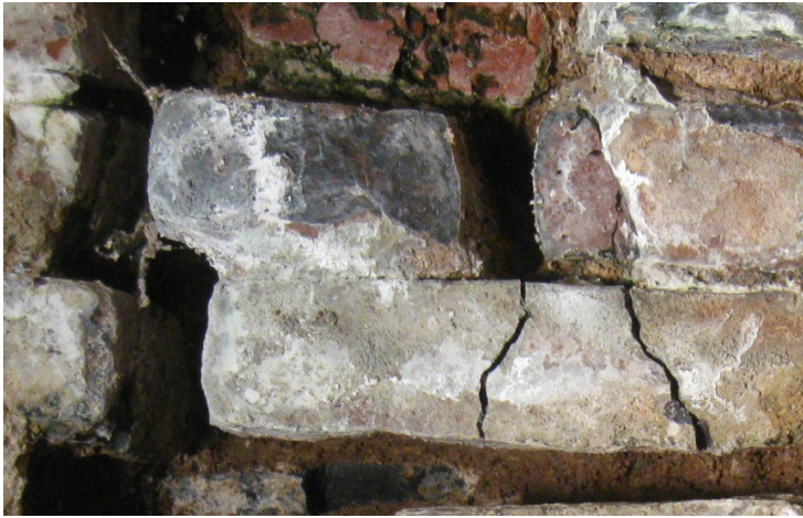
KUVA 2. Tiilen pinnan lohjetessa alta on paljastunut mustunut pinta.
