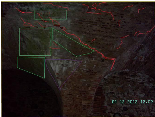
KUVA 19. II b ruoteen yli kulkeva halkeama.
