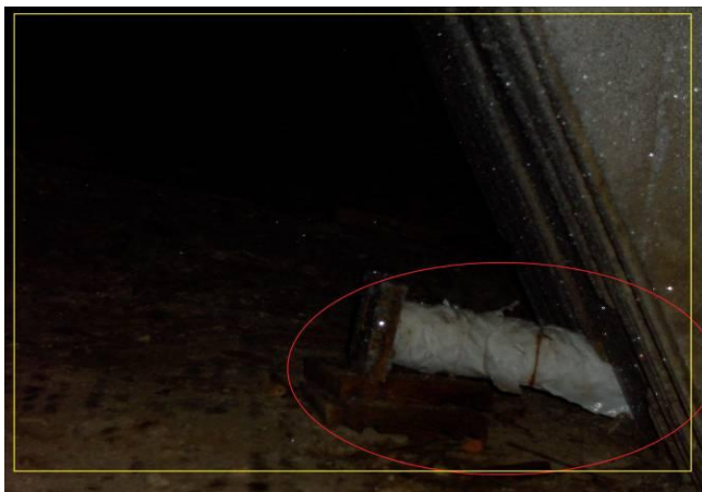
KUVA 13. Betonisen tukipalkin sisältä tuleva putki on tukittu. Tukkimisessa on käytetty muovia ja puuta.
