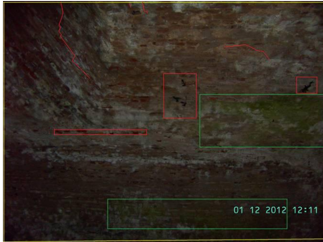
KUVA 23. III b, yläpuolisissa rakenteissa käytetty eristysaine on päässyt valumaan rakenteen läpi.
