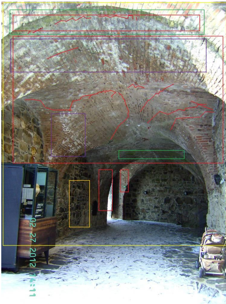
KUVA 14. Yleiskuva kurttiinista Vesiportin bastionin pihan puolelta. Kuvaan on merkitty vaurioituneemmat kohdat.
