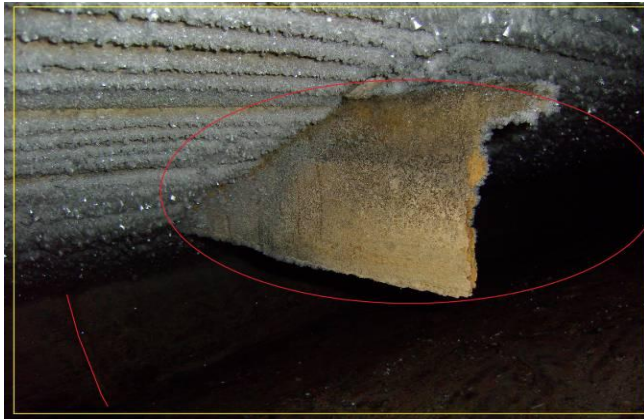
KUVA 12. Puukuitulevyä roikkuu valettujen betonilaattojen välistä.
