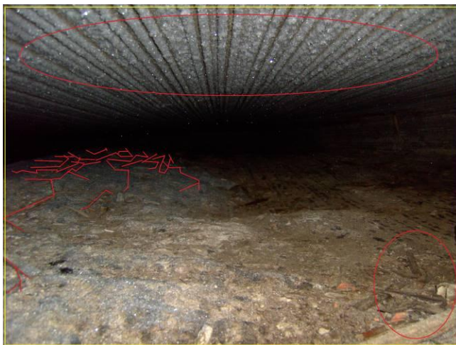
KUVA 11. Tämän kaltaisessa muuratussa rakenteessa on aina halkeamia. Kuvassa näkyy holvin halkeamia, jotka eivät vielä ole varsinaisia repeytymiä.
