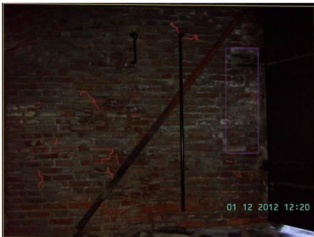
KUVA 30. VI a, ulko-oven vasemman puolen rakenteessa esiintyy suolaa.
