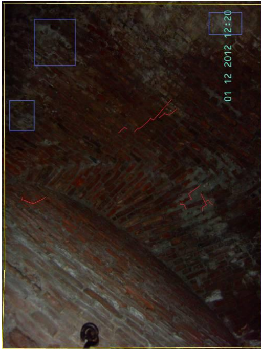
KUVA 29. V c, oven oikealla puolella tiilirakenteissa on vähäisiä vaurioita.
