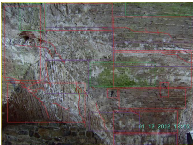
KUVA 33. VIII b, holvin rakenne on pahasti vahingoittunut siinä risteilevien halkeamien vuoksi.
