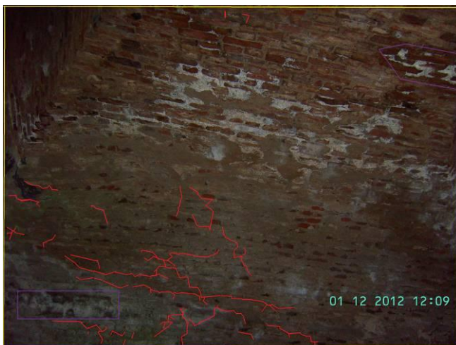
KUVA 20. II c, kosteutta on runsaasti myös tässä rakenneosassa.
