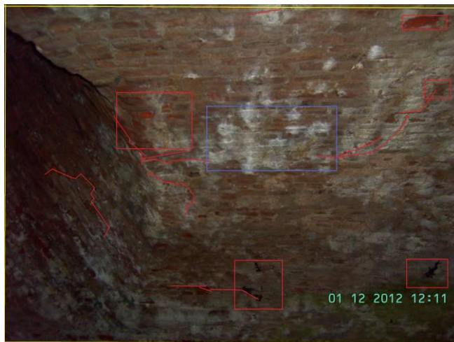
KUVA 24. III c, kohtisuoraa ylöspäin otetussa kuvassa nähdään useampi halkeama.
