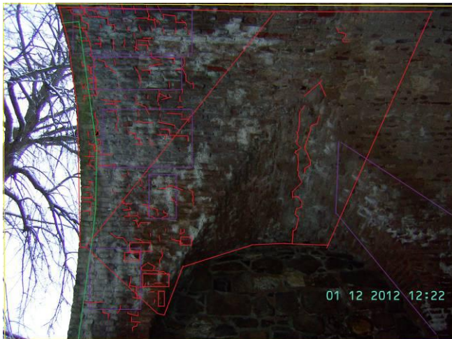
KUVA 37. X b, holvin ja kaaren vaurioita.
