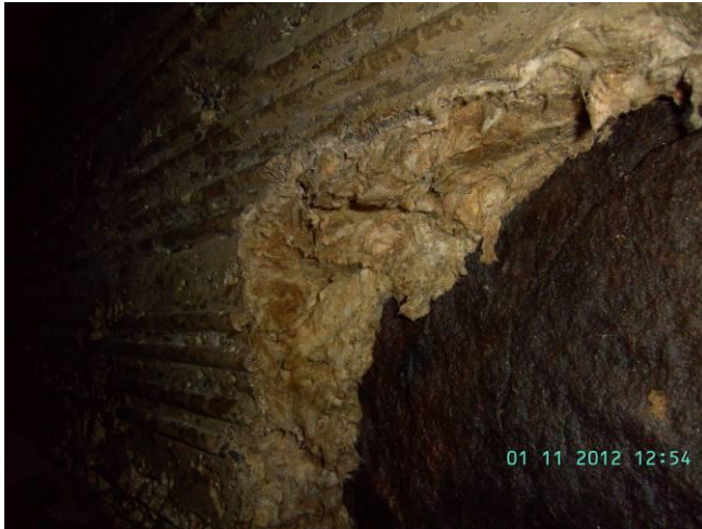
KUVA 3. Betonipalkin valun yhteydessä on käytetty lasivillaa, joka ei kastuttuaan kuivu ja pitää näin ympäristönsä hyvin märkänä.
