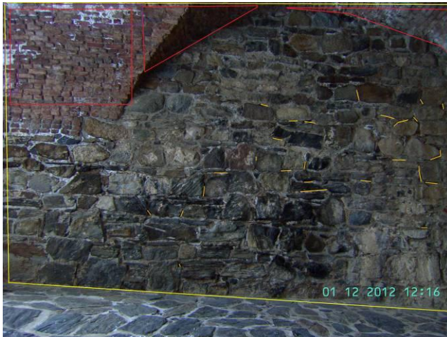
KUVA 34. IX a, luonnonkivimuurin saumauksia tulee uusittavaksi.
