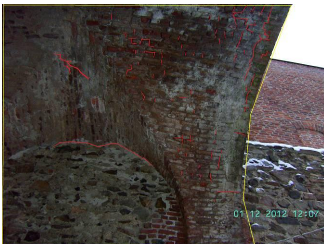
KUVA 16. I b, tiiliosiossa on vaurioita esim. halkeama holvissa.
