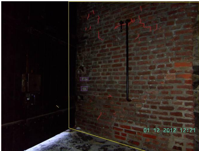
KUVA 27. V a, ulko-oven oikealla puolella on vain vähäisiä vaurioita. Osa on aiheutunut hakojen kiinnityksestä.
