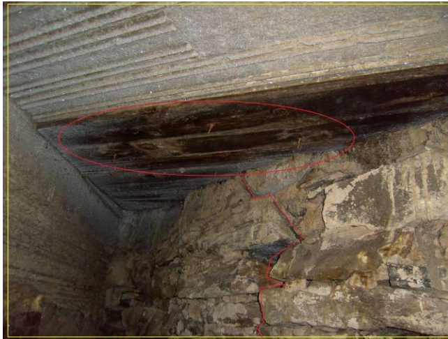
KUVA 10. Valun laudoitusta on myös havaittavissa.
