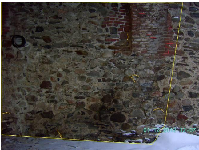
KUVA 15. I a, luonnonkivimuuri on hyvässä kunnossa, eikä tarvitse toimenpiteitä. Tiiliosiossa on vain vähäisiä vaurioita.
