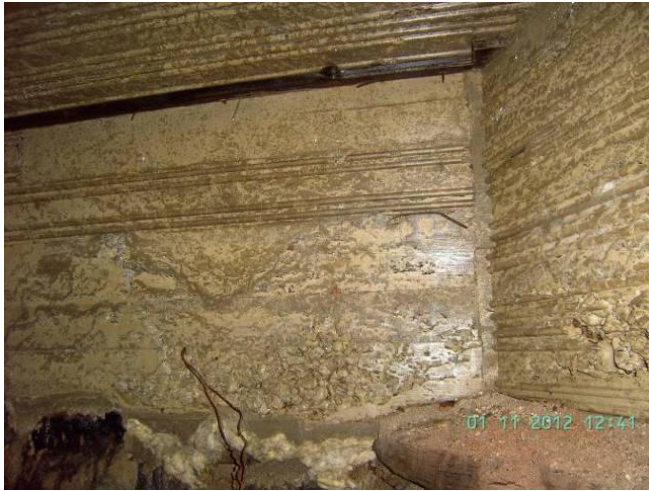
KUVA 5. Rakenteisiin on jätetty laudoitusta.
