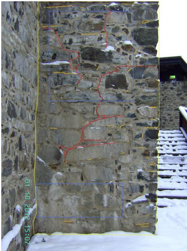
KUVA 41. Halkeamat kulkevat lähes koko muurin korkeudelta.
