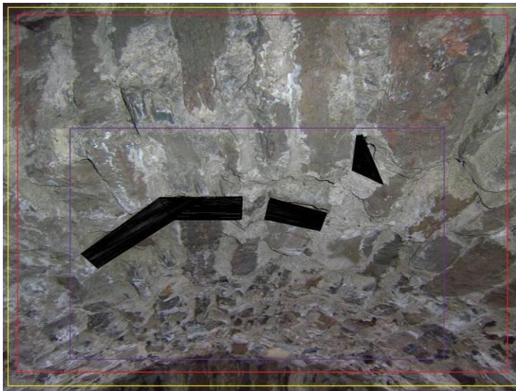
KUVA 11. Ensimmäisestä holvista on jo pudonnut kivimateriaalia.
