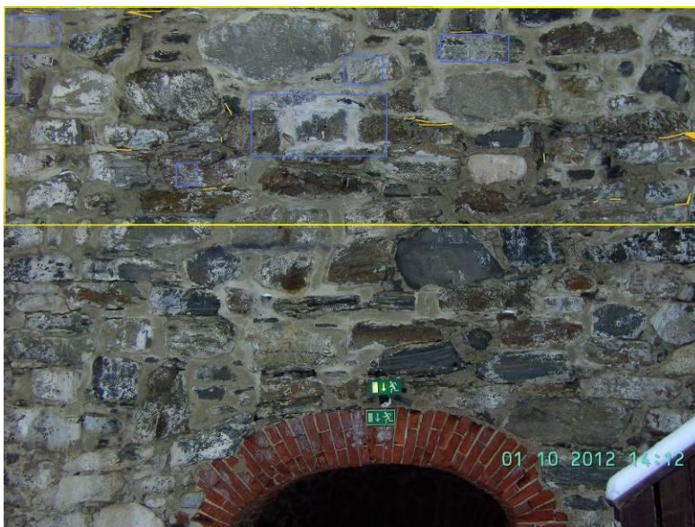
KUVA 18. Ylempänä rakenteessa on vähäisessä määrin auki olevia saumoja ja paikoitellen kalkkilaasti valumia.
