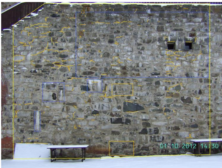
KUVA 36. Saumauksissa on puutteita ja muurissa kalkkisia valumia.
