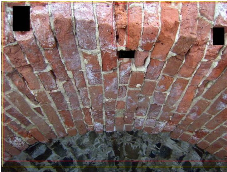
KUVA 8. Kotkanportin tiilikaari on myös menettänyt materiaalia.
