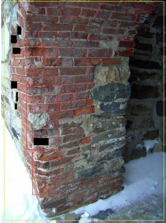
KUVA 7. Kotkanportin vasen puoli, tiilimateriaalia on menetetty.
