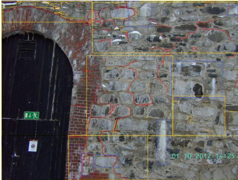
Kuva 35. Muurin alaosassa on rakenteellisia vaurioita. Se on halkeamien peitossa.
