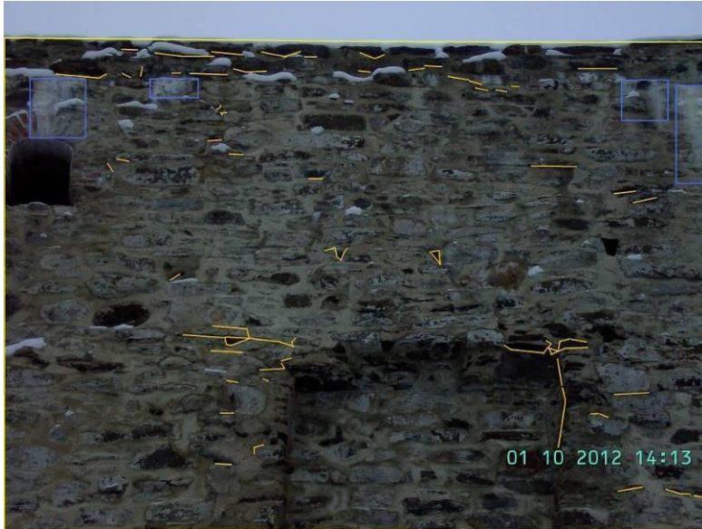
KUVA 21. Komeron yläkulmat kaipaavat uudelleen saumausta.
