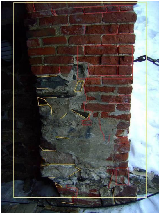
KUVA 9. Aiemmin suoritettu paikkaus voitaisiin uusia muun restauroinnin yhteydessä, koska se on esteettisesti ruma.
