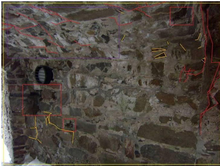
KUVA 13. Oikeassa seinämuurissa on myös rakenteellisesti merkittäviä halkeamia. Suolaa on näilläkin pinnoilla.
