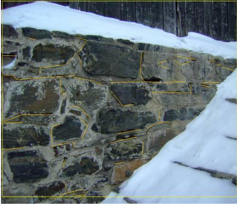
KUVA 29. Oven alapuolinen osio on kuitenkin saumattava kokonaan uudelleen. Lumi kinostuu portaille ja oven eteen.
