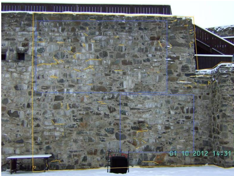
KUVA 37. Vajaita saumauksia ja kalkkisia valumia.
