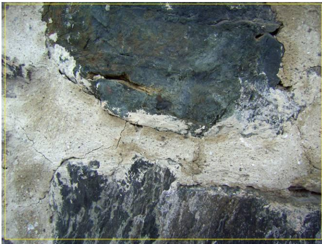
KUVA 3. Saumat eivät ole tiiviisti kivenpinnassa kiinni ja vedellä on näin vapaa pääsy rakenteisiin.
