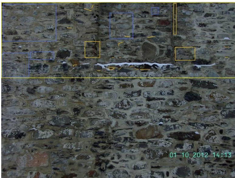
KUVA 20. Saumausvaurioita on komeron sivuilla ja alapuolella.
