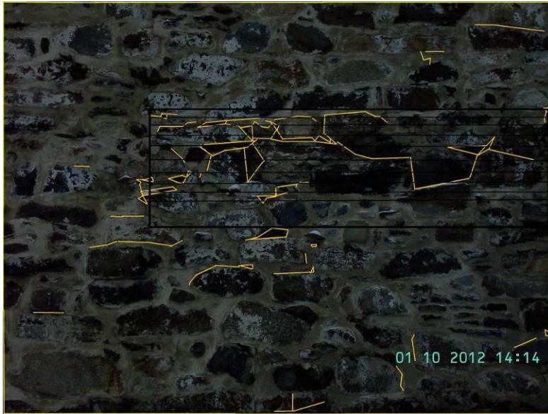
KUVA 24. Avonaiset saumaukset ovat päästäneet vettä rakenteeseen.
