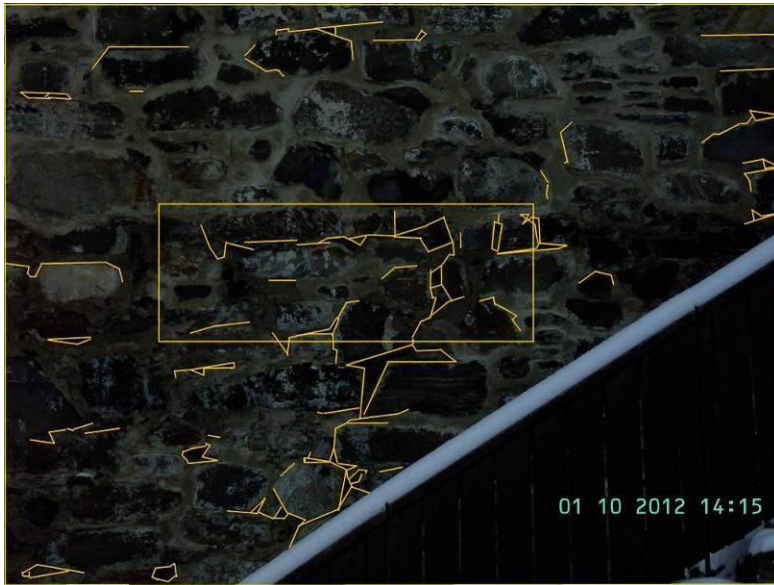
KUVA 26. Yhtenäisempi vaurioitunut alue kehystettynä ja vauriot jatkuvat sen alla samankaltaisina.
