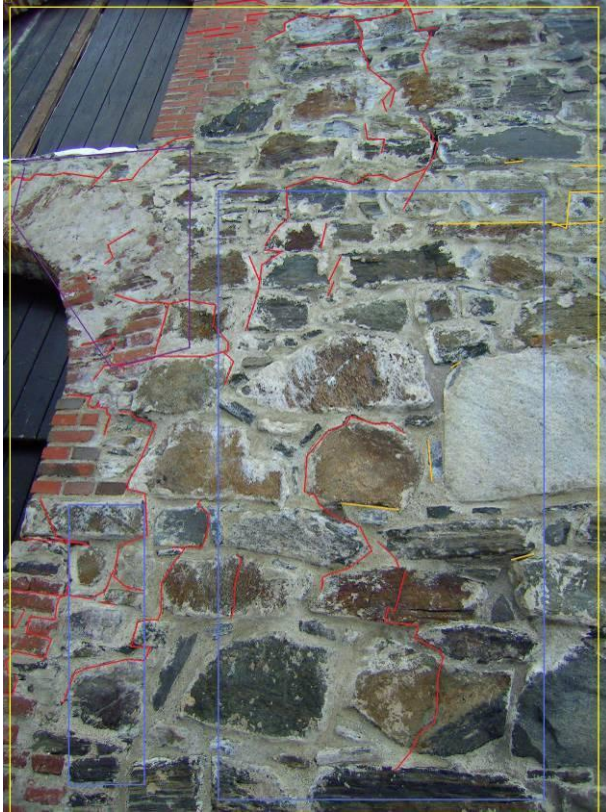
KUVA 31. Tasanteelta kohoavassa muurissa on halkeamia ja kalkkisia valumia.
