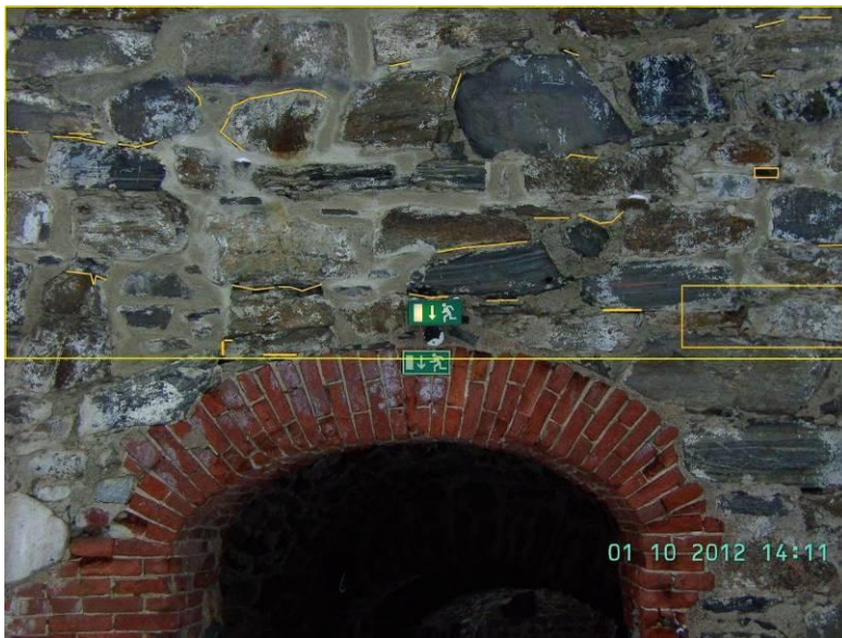
KUVA 17. Muurissa on puutteellisesti saumattuja saumauksia.
