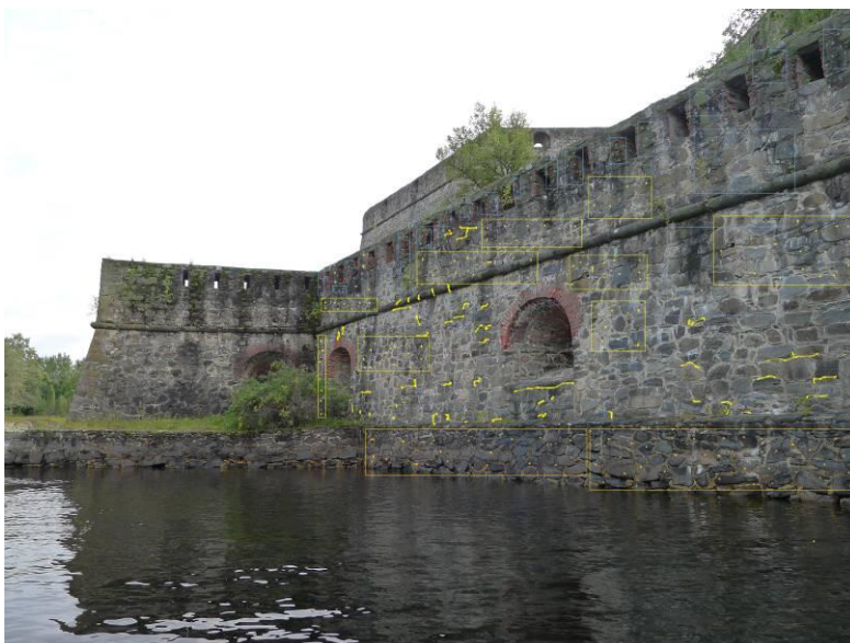
KUVA 16. Suvorov, muuri IV, as.21, vasen. Muureissa runsaasti kasvustoja, saumaukset on uusittava ja tiiliosiot kaipaavat restaurointia.
