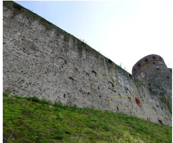
KUVA 24. Kijlin tornin ja Kirkkotornin välinen muuri III. Rumat kalkkiset valumat.
