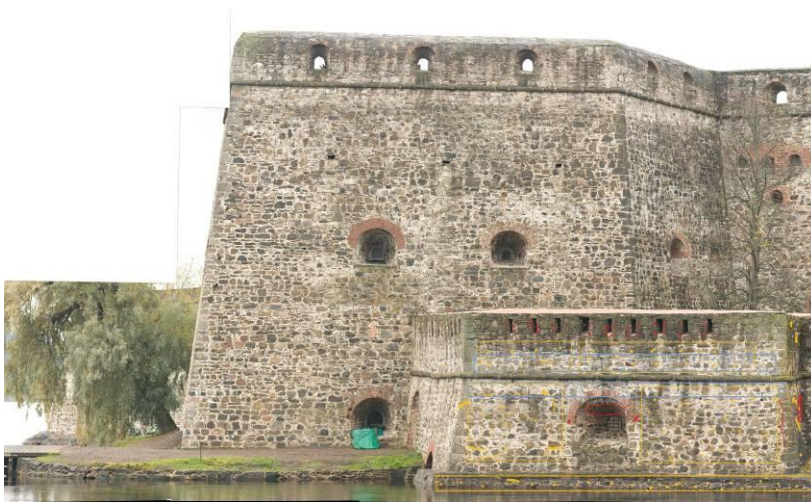
KUVA 14. Suvorovin päätymuuri II. Myös tiiliosiot kaipaavat restaurointia. Halkeama kulkee oikeassa nurkassa ja valumia on koko muurin leveydeltä.
