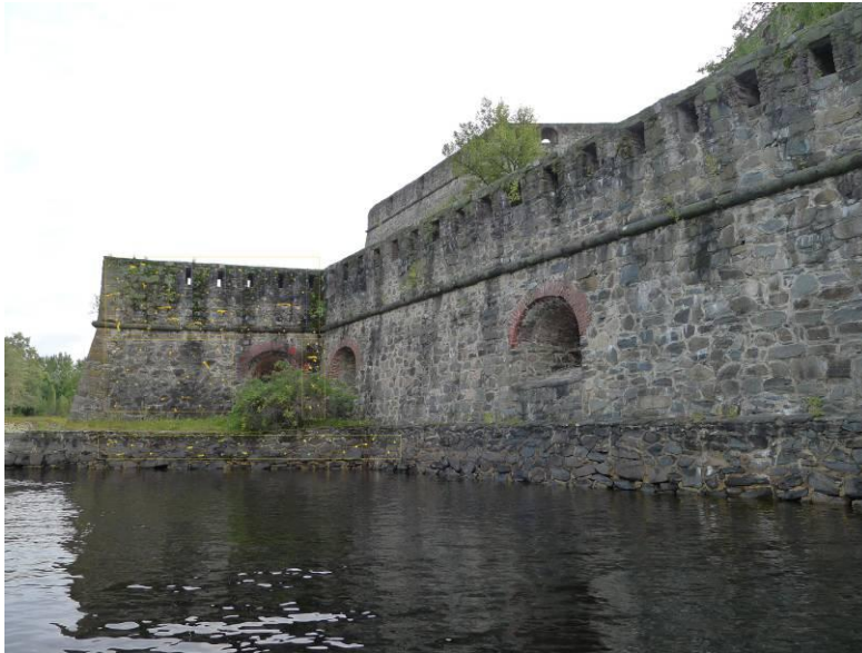
KUVA 15. Suvorov, muuri III. Kasvustot ovat vallanneet muurin ja pitävät kivissä yllä korkeaa kosteuspitoisuutta.
