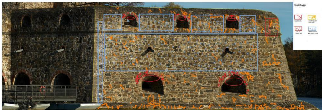
KUVA 3. Vesiportin bastionin II muuri. Kuvassa on myös vauriotyyppiluokitus.
