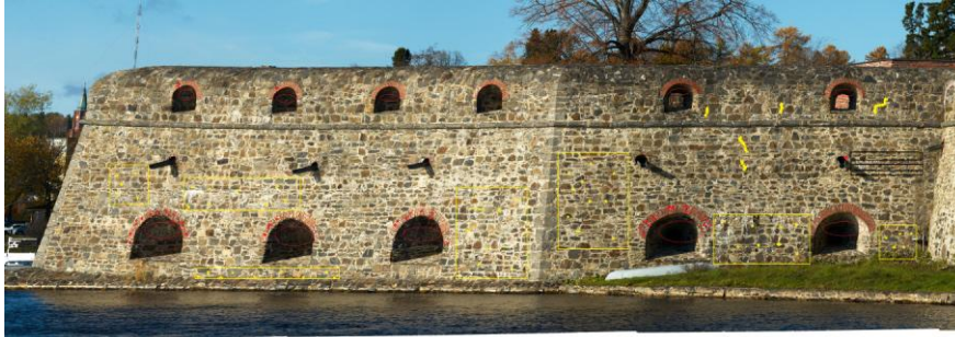
KUVA 4. Vesiportin bastionin III ja IV muuri. Laastisaumojen uusiminen on ajankohtaista laajoilla alueilla.
