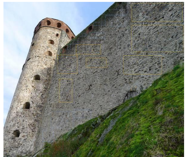
KUVA 22. Kijlin tornin ja Kirkkotornin välinen muuri I. Yläosassa kasvustoja.
