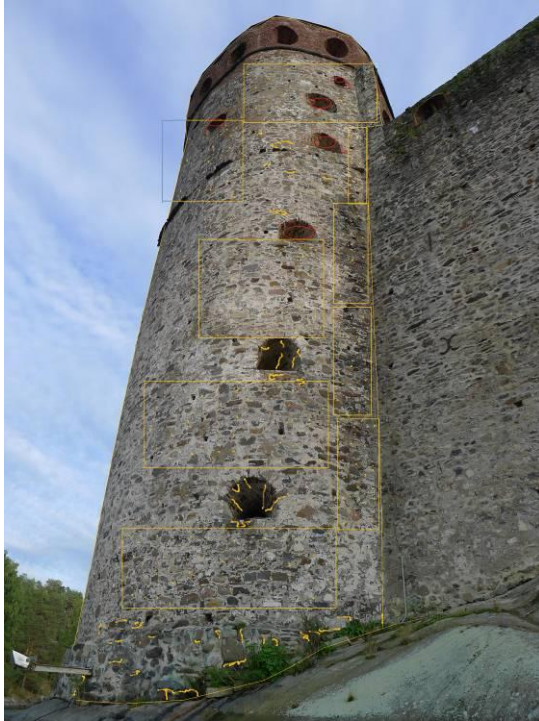
KUVA 21. Kijlin torni, muuri III. Saumaukset on uusittava.
