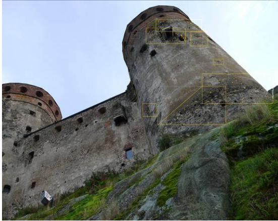
KUVA 27. Kellotornin ala-osa on vaurioitunut ja saumaukset on syytä uusida.
