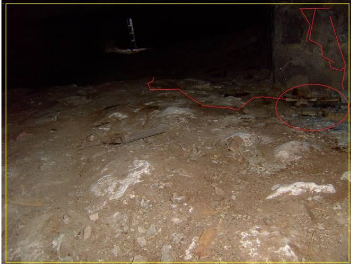
KUVA 13. Kuudennen kasematin holvin etupuolella on repeämä. Kivimuureissa on myös tilan molemmin puolin halkeamia.
