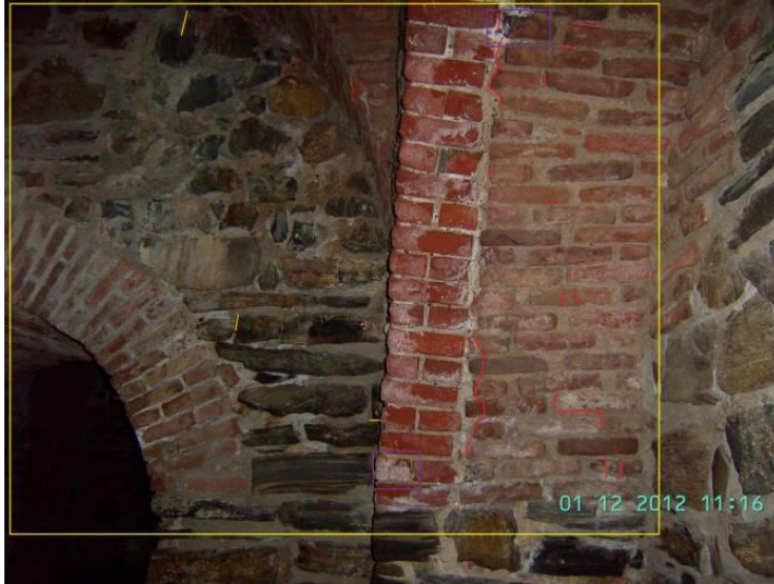
KUVA 111. VI b, tiilikaassa on pari halkeamaa.
