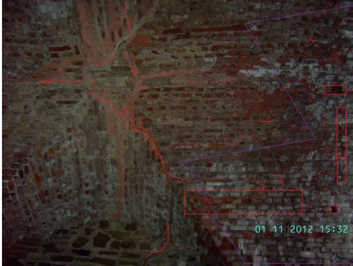
KUVA 64. II b, ovi-aukon yläpuolisessa holvissa on halkeamia.
