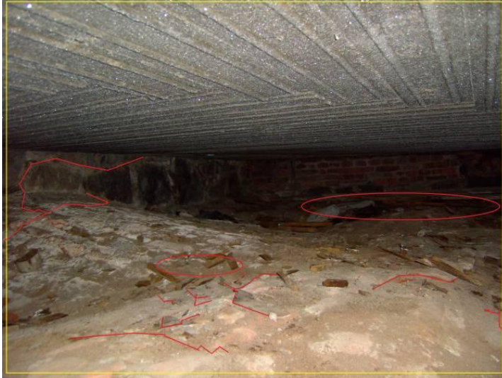
KUVA 19. Viimeisen kasematin holveissa on halkeamia.
