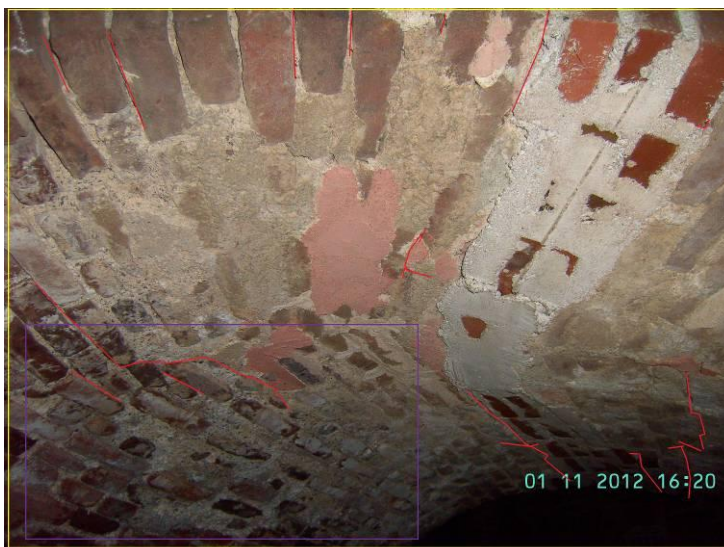
KUVA 97. I b, holvissa on uusia halkeamia.
