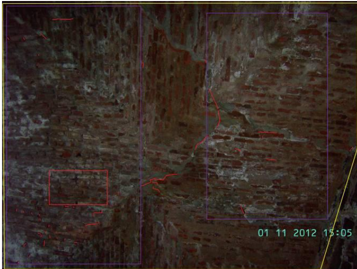
KUVA 45. II c, holvin halkeama on jo aiemmin korjattu.
