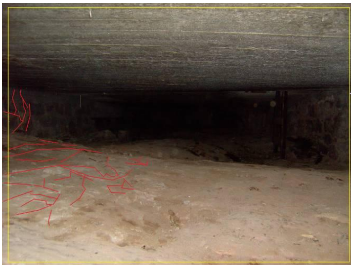
KUVA 6. Kolmannen kasematin holvit ovat pahoin repeytyneet. Kuvassa näkyy tikapuut, joiden olemassaolosta ei ollut etukäteistietoa.
