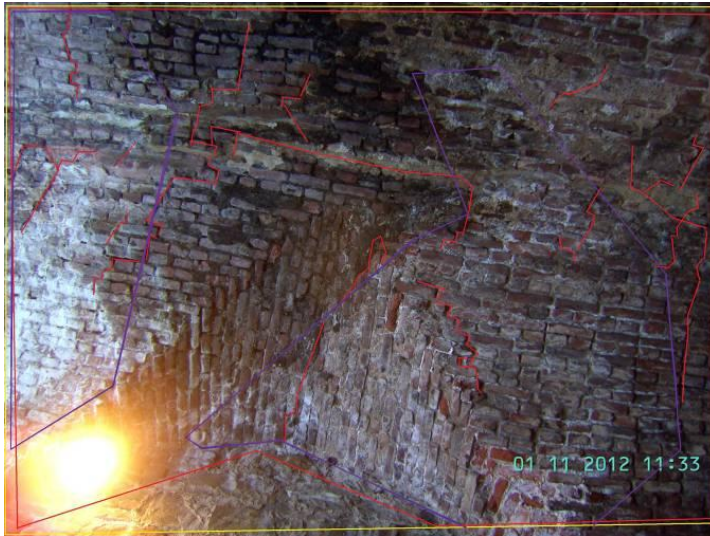
KUVA 25. II c, halkeamia risteilee rakenteessa.
