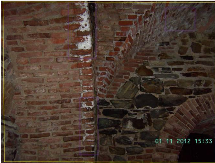
KUVA 66. III b, rakenteessa on suolapartaa.
