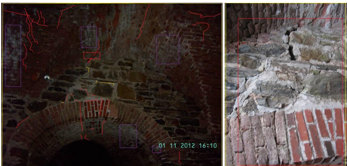
KUVA 91 A. VI b, holvin tiilikaareissa on halkeamat ja myös holvissa on halkeamia. KUVA 91 B. Lähikuva vauriosta.
