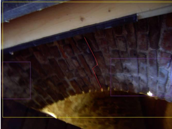
KUVA 54. Kaaressa on halkeama ja suolaa.
