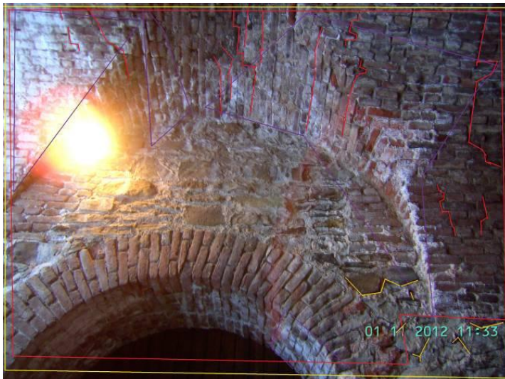
KUVA 24. II b, holvissa on halkeamia ja saumaukset ovat rapautuneet.
