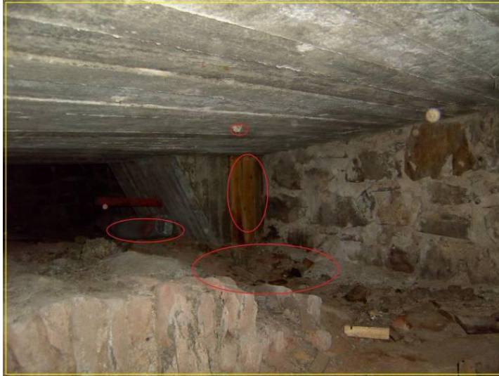
KUVA 3. Maatuvu puumateriaali kerää turhaa kosteutta rakenteisiin.
