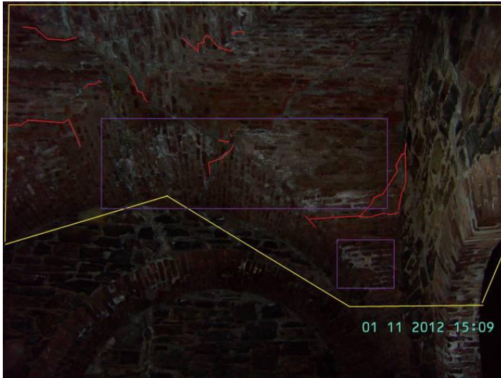
KUVA 47. III b, holvin aiemmin korjattu halkeama on antanut vähän periksi.
