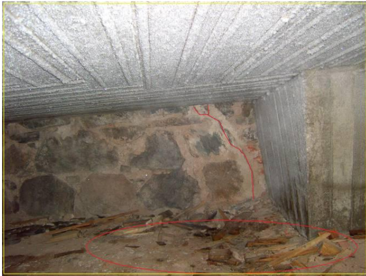
KUVA 17. Luonnonkivimuurissa on pystysuora halkeama.
