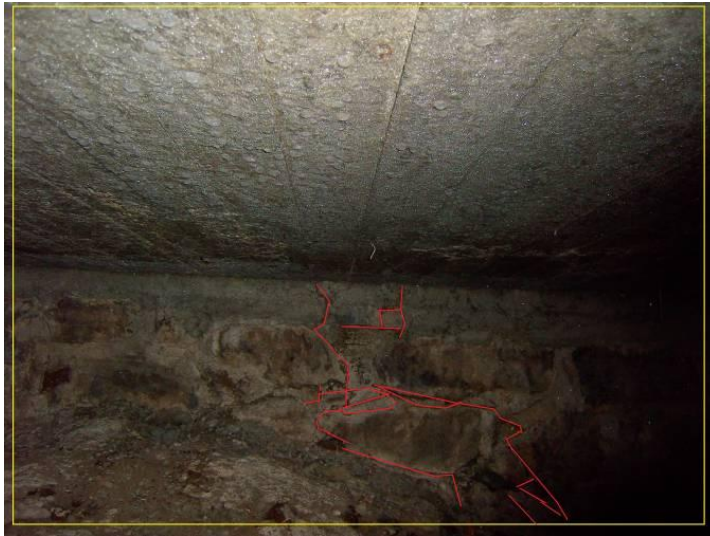
KUVA 7. Kolmas kasematti ja sen kohdalla kivimuurissa on halkeamia.
