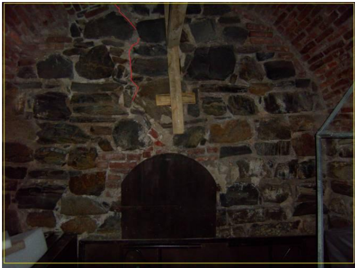
KUVA 57. Takaseinämuurissa on halkeama.
