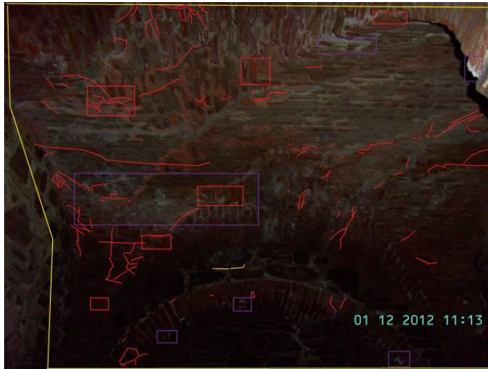
KUVA 109. V b, holvissa on runsaasti halkeamia.
