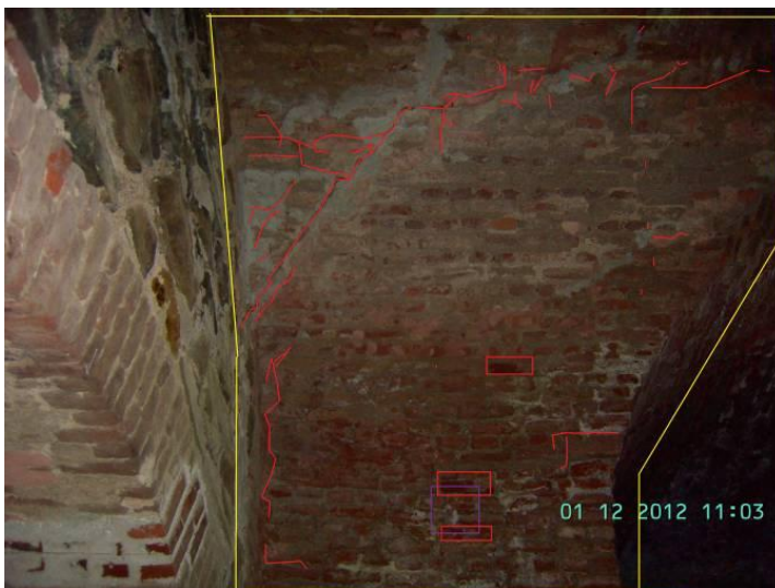
KUVA 104. II b, holviin aiemmin suoritettu korjaus on pettänyt ja halkeamia on syntynyt lisää.
