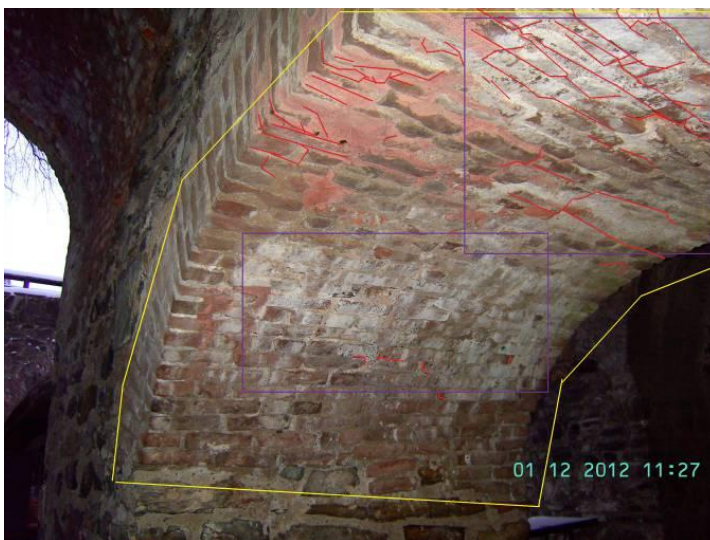
KUVA 117. I b, väliholvissa on runsaasti halkeamia.
