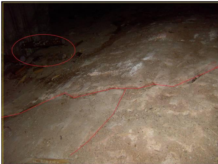
KUVA 16. Väliholvissa on poikittainen repeämä.
