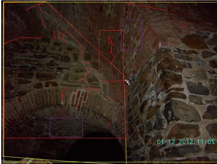
KUVA 105 A. III b, väliholvin yläpuolella on uusia halkeamia.
