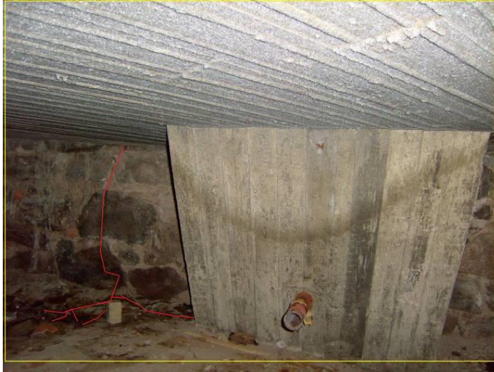
KUVA 15. Vastakkaisella puolella on halkeama kivimuurissa.
