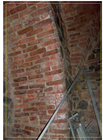
KUVA 58. Oikealla puolella tiilikaarta on halkeama.
