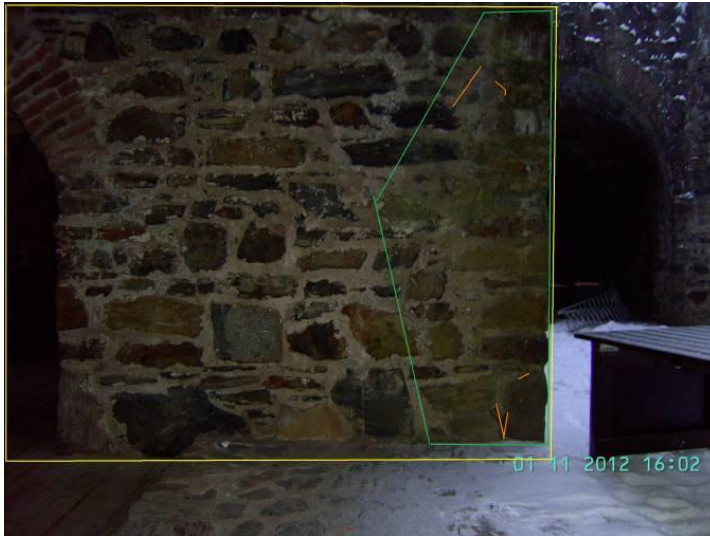
Kuva 82. I a, vauriot ovat vähäisiä, leväkasvustoa on runsaasti.
