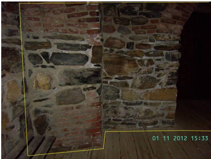
KUVA 65. III a, kasematin oikea nurkka on kunnossa.
