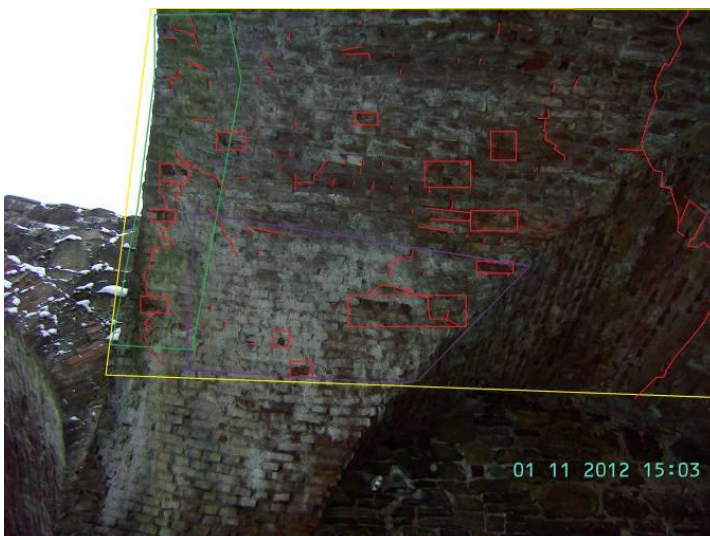
KUVA 42. I c, holvissa on myös halkeama, joka ylittää ruoteen.
