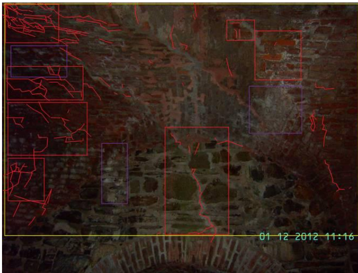
KUVA 113. VII b, holvi on todennäköisesti kovin kostea. Leväkasvustoa on halkeaman ympärillä ja holvin tiilet näyttävät tummilta.
