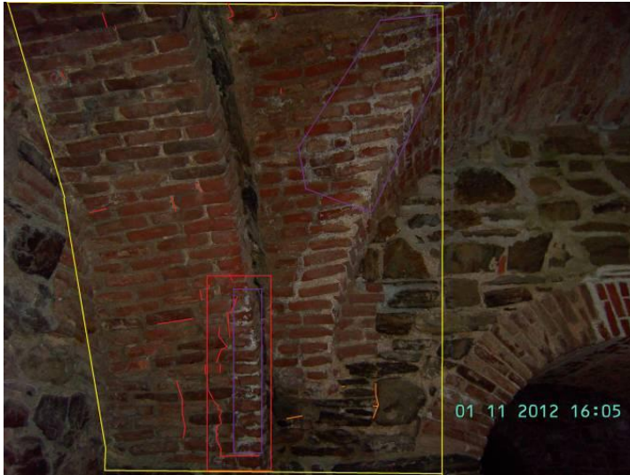
KUVA 88. III b, takaseinämän tiilikaassa on halkeamia.
