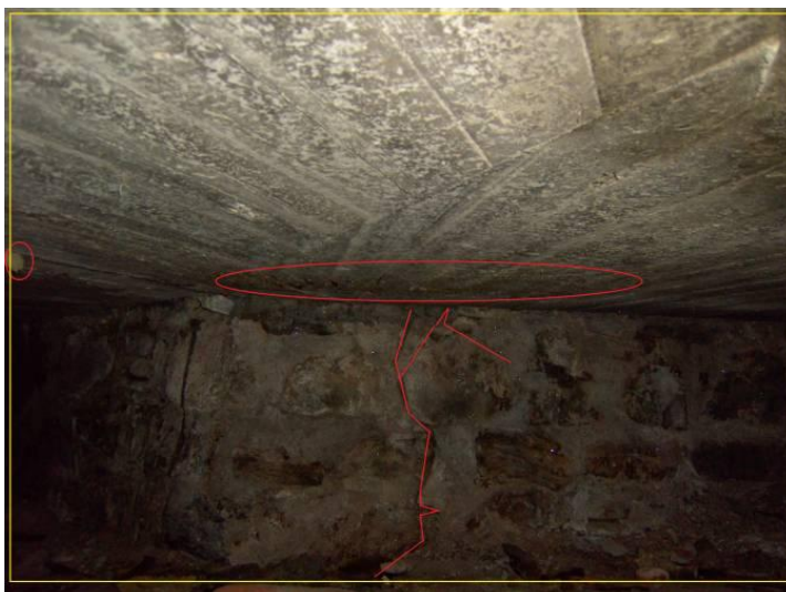
KUVA 8. Kulmamuurissa on halkeama ja tilan katelaatan raudoitukset ovat ruostuneet.
