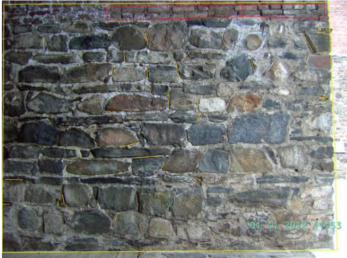
KUVA 35. VII a, luonnonkivimuurin saumaukset ovat puutteelliset.
