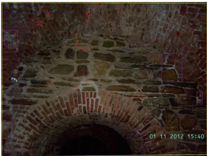
KUVA 73. VI b, kohdassa on holvin päällä oleva aiempi korjaus antanut periksi.
