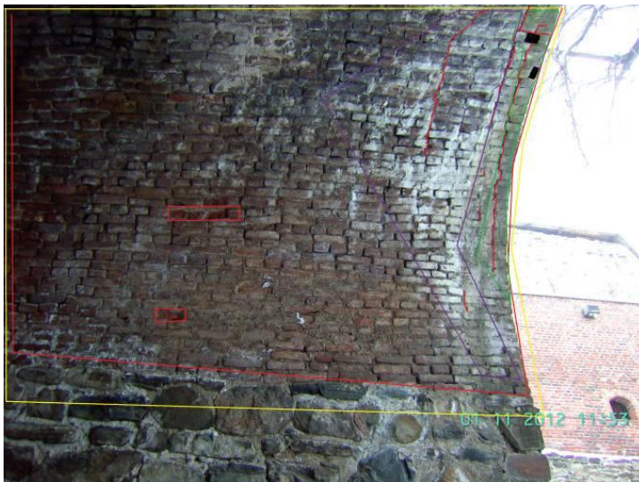
KUVA 36. VII b, koko tiilimuuratun alueen kaikki saumaukset ovat rapautuneet.
