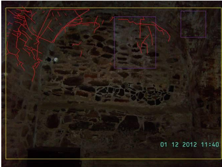
KUVA 129. IV a, vasemman seinämän vaurioita, suolaa on myös kivimuurissa.
