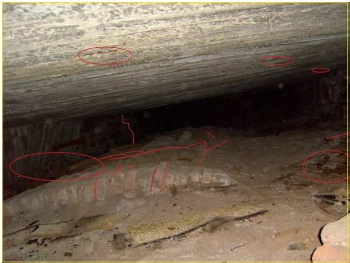
KUVA 10. Väliholvissa kulkee poikittainen halkeama.
