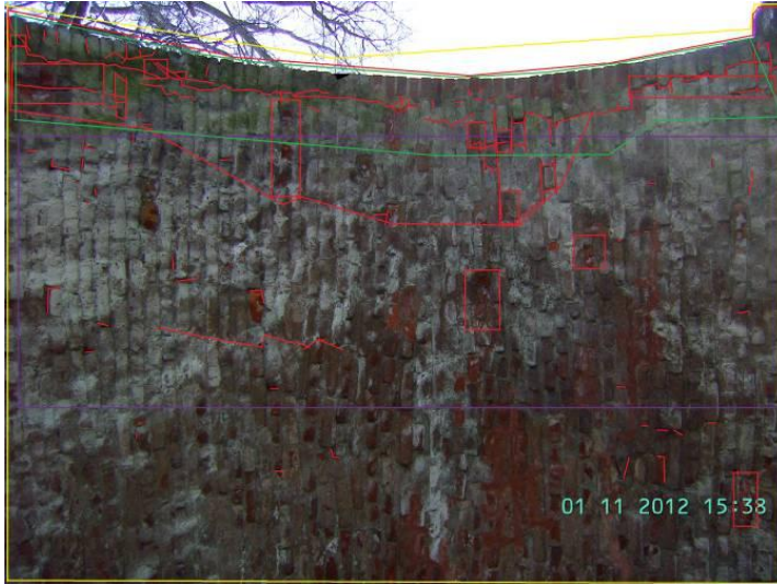
KUVA 76. VII c, rapautuneita tiiliä ja kaaren uloimmassa varvissa on merkittävä halkeama.
