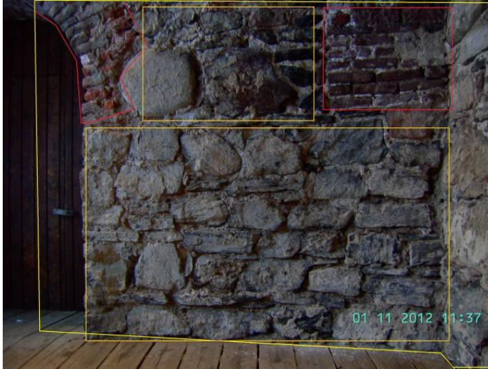
KUVA 27. III a, kivimuurissa on saumausta kaipaava kohta ja tiiliosiot kaipaavat myös uudelleen saumausta.
