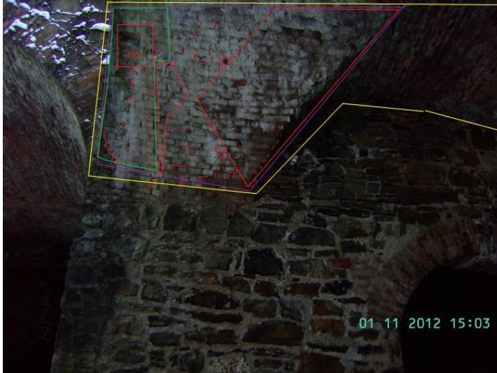
KUVA 41. I b, koko kaaren alueella on saumauksissa puutteita.
