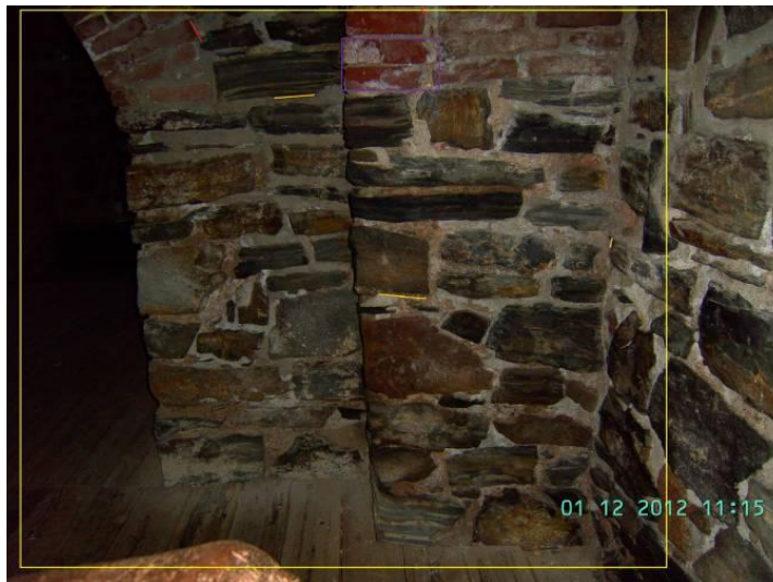
KUVA 110. VI a, osiolla ei ole vaurioita.
