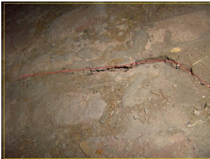
KUVA 4. Kuvassa on ensimmäisen ja toisen kasematin väliholvin repeämä.
