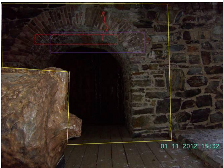
KUVA 63. II a, halkeama kaareissa ja rakenteessa on runsaasti suolaa.
