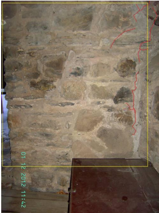
KUVA 131. V a, muurin syvennyksessä on halkeamia.
