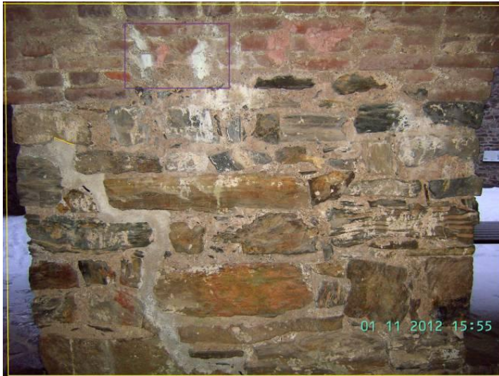
KUVA 77. I a, aiempi halkeaman täyttö on kunnossa.
