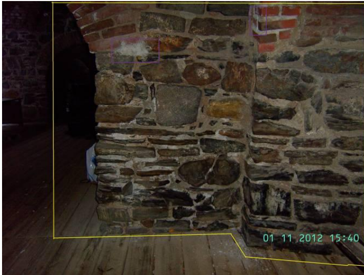
KUVA 70. V a, rakenteessa on vähäisessä määrin suolaa.
