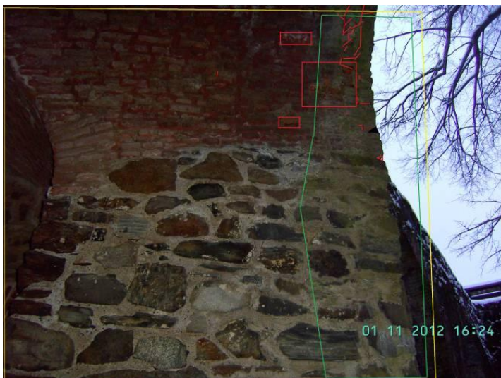
KUVA 102. I b, kaaren alueella on halkeamia.
