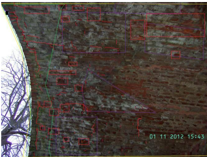
KUVA 75. VII b, tiiliosiossa on rapautuneita tiiliä, suolaa ja leväkasvustoa. Uloimmassa tiilivarvissa on halkeamia ja se on irtoamassa muusta rakenteesta.
