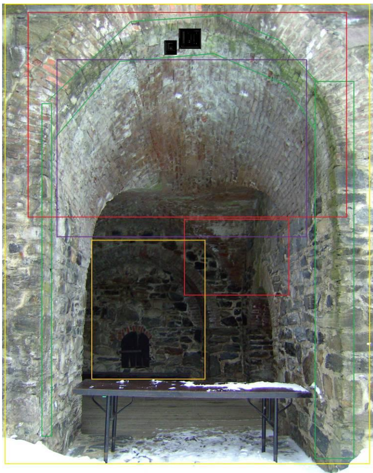
KUVA 120. Yleiskuva on kahdeksannen kasematin vaurioista.
