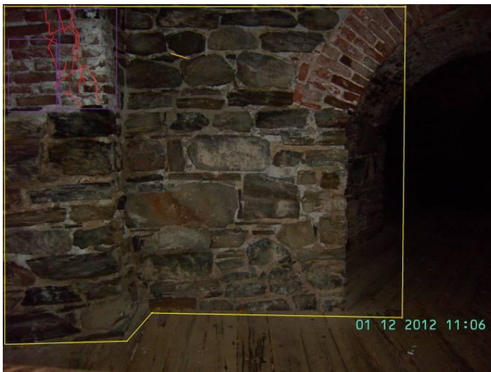
KUVA 106. IV a, tiilikaaren halkeamia ja suolaa.
