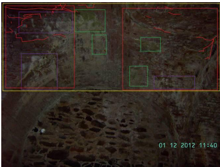
KUVA 130. IV b, holvissa vasemman seinämuurin yläpuolella on restauroitavaa.
