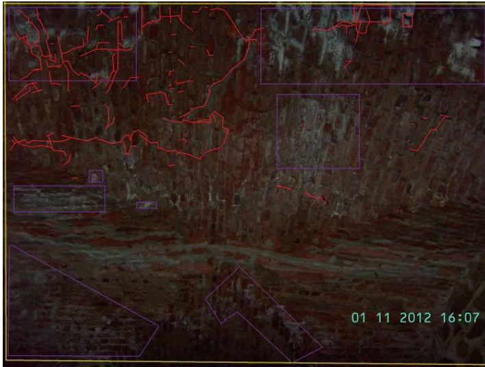
KUVA 92. VI c, holvin halkeamat keskittyvät väliholvin yläpuolelle.
