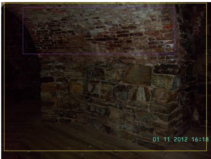
KUVA 99. I c, väliholvin oikea puoli on kunnossa.
