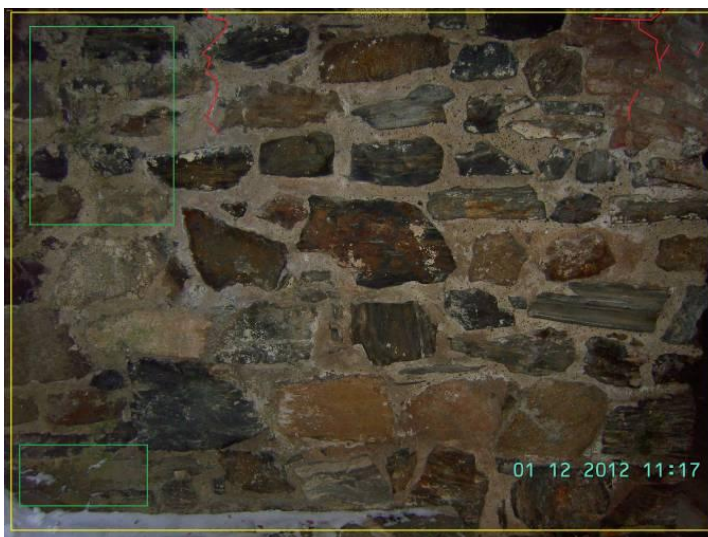
KUVA 114. VIII a, luonnonkivimuurissa on leväkasvustoa ja pari halkeamaa.
