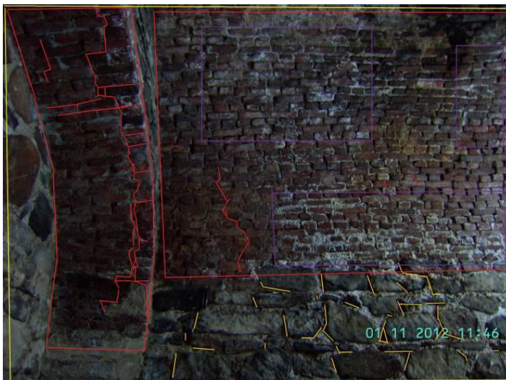
KUVA 32. V b, tiilikaarella ja myös holvirakenteen ala-osassa kulkee halkeamat.
