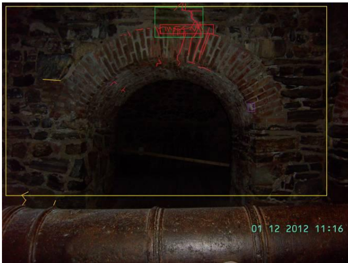
KUVA 112. VII a, väliholvissa ja sen yläpuolella on repeämä.
