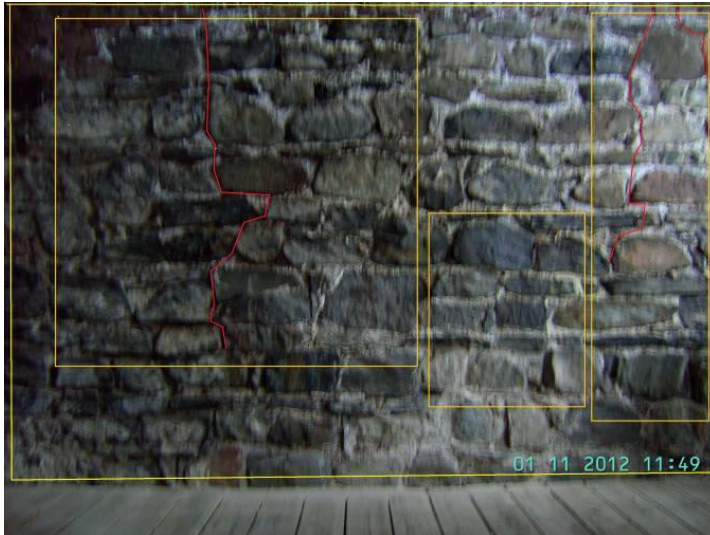
KUVA 33. VI a, kivimuurissa on pystysuorat halkeamat.
