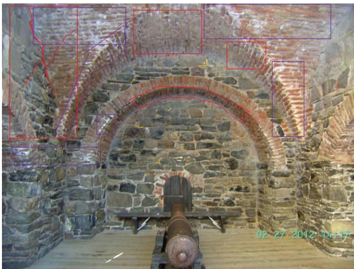
KUVA 89. IV a, merkittävät repeämät väliholvin yläpuolella ja oikealla ruoteessa.
