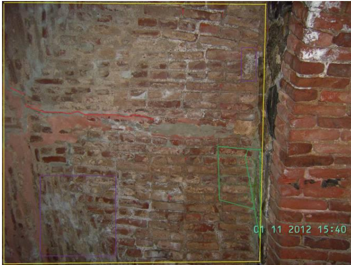
KUVA 72. V c, aiemmin korjattu kohta on halkeillut.
