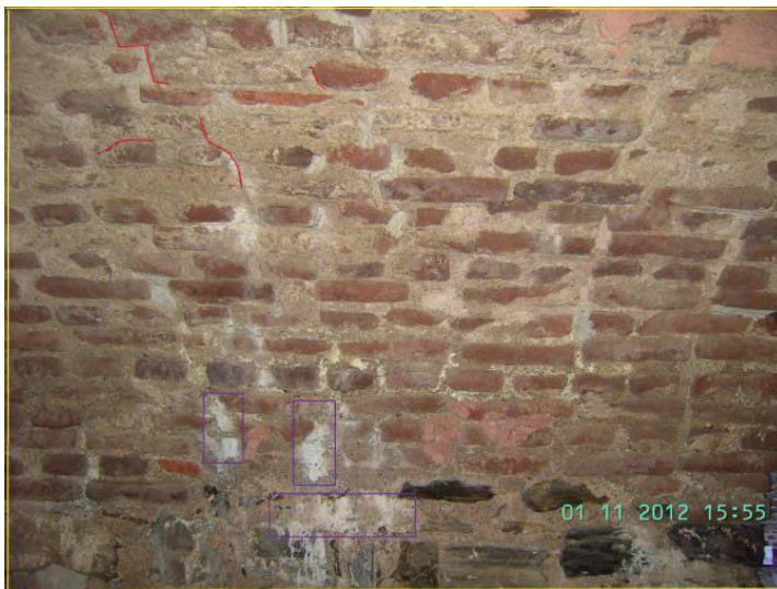
KUVA 78. I b, ylempänä rakenteessa on vain vähäisiä puutteita saumauksissa.
