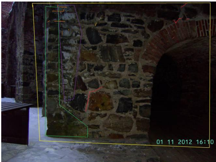
KUVA 93. VII a, leväkasvustot ja suola rasittavat rakennetta.
