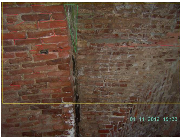
KUVA 67. III c, vaurioita kaaressa ja holvissa.
