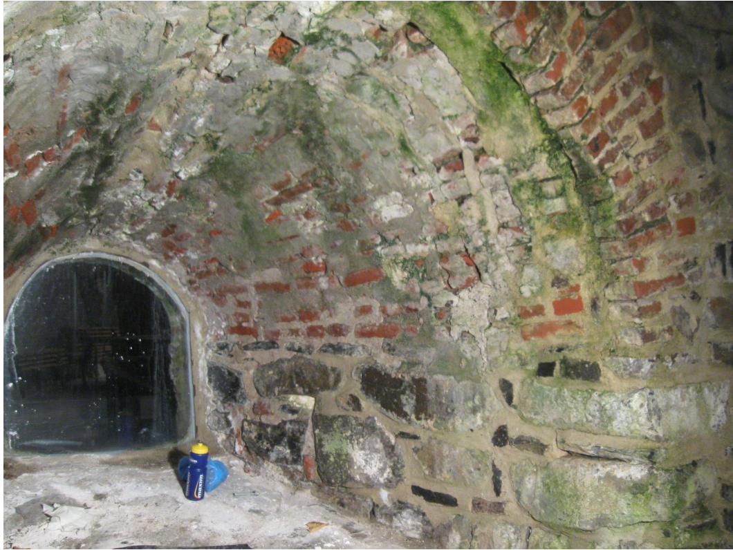
KUVA 8. Umpeen rapattua tiilipintaa ja leväkasvustoa.
