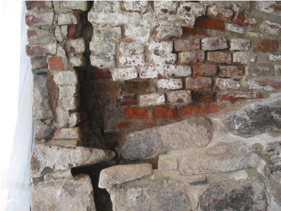
KUVA 6. Purettua aluetta ja holvikaaren halkeama.
