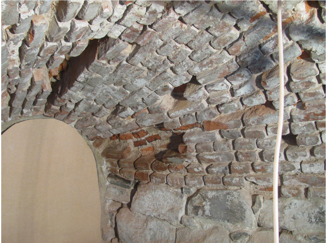
KUVA 3. Ampuma-aukossa L-106 useat tiilet irtosivat laastisaumojen piikkauksen yhteydessä.
