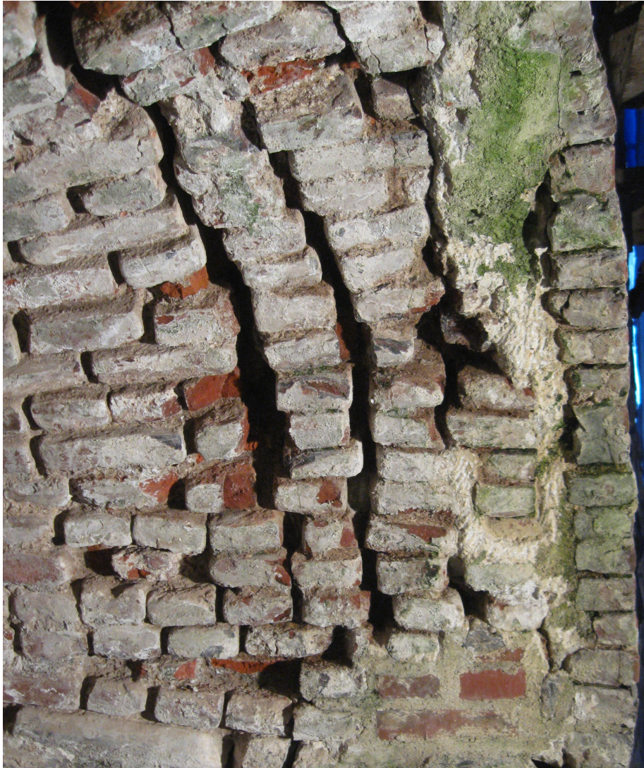
KUVA 7. Auki piikattuja halkeamia. Oikealla ylhäällä laastilla täytetty halkeama.
