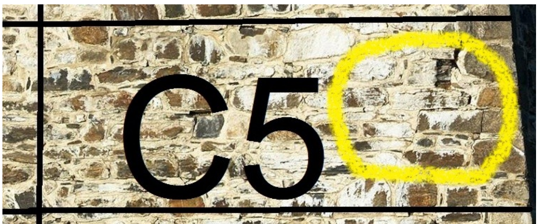
KUVA 17. Pullistuma lohko C taso 5.
