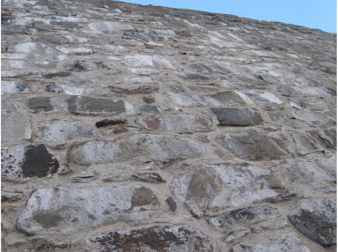
KUVA 2. Seinät olivat kohtuullisen hyvässä kunnossa.
