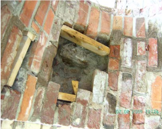
KUVA 31. Halkeaman avaus osoitti suurehkon vaurioalueen, joka muodosti uhan vierailijoille.
