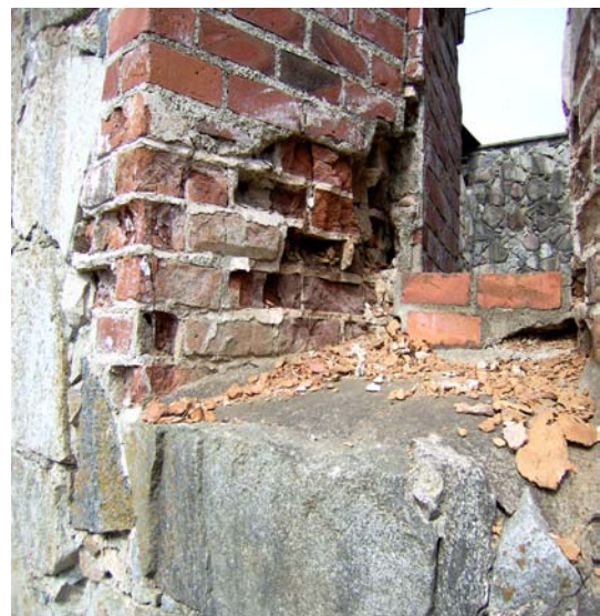
KUVA 38. Vaurion etenemä yhden talven aikana.
