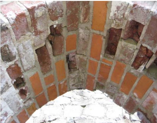
KUVA 6. Aiemmat sementtillaastilla tehdyt korjaukset ovat kiihdyttäneet rapautumista.
