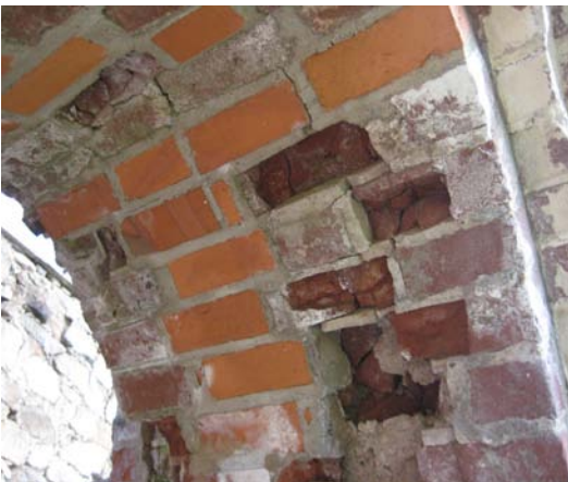
KUVA 8. Korjauksissa käytetyt tiilet eivät sulaudu alkuperäiseen ympäristöön.
