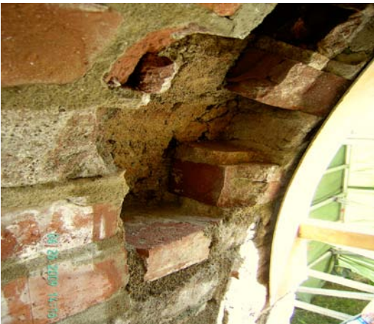
KUVA 29. Sementtilaastin aiheuttamat tuhot ja heikentyneitä, haperoita taustarappausa.
