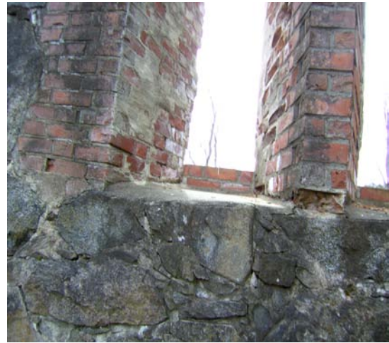
KUVA 52. Kuvassa ikkuna-aukon A 2 rapautuneet alueet.
