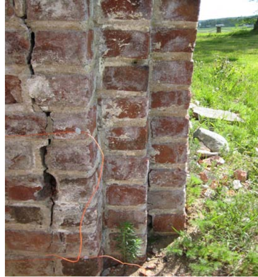
KUVA 3. Vauriot eivät ole paikallisia vaan vauriot kattavat koko sisäänkäynnin.
