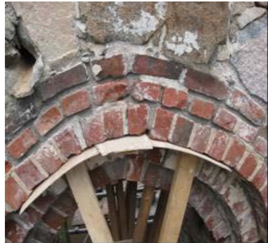
KUVA 18. Holvitiilistä poistettiin kutistuneet ja rakoilleet sementtisaumat restauroinnin aikana.
