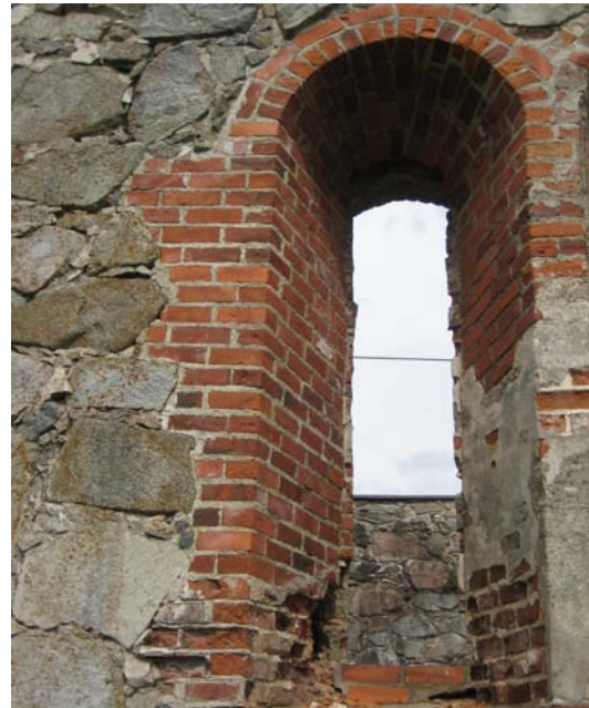
KUVA 11. Vaurioituneimmat alueet sijaitsevat ala- osissa joihin lumi kertyy ja viipyy pisimpään.
