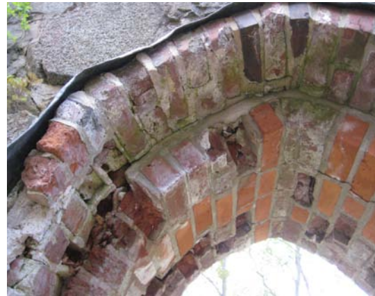
KUVA 7. Liian luja laasti murtaa tiilen ja aiheuttaa rakoilua rakenteessa.
