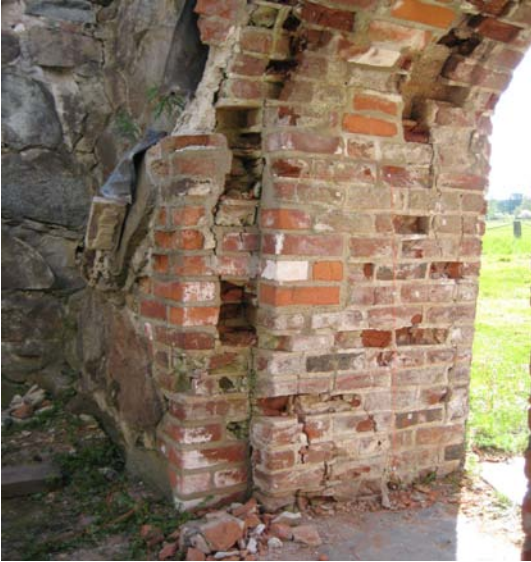
KUVA 2. Sisäänkäynnin vakavat rakenteelliset vauriot ilmenevät halkeamina.
