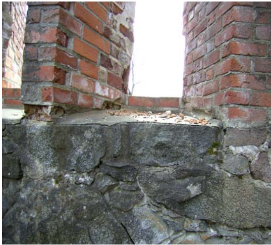
KUVA 51. Kuvassa ikkuna-aukon A 1 rapautuneet alueet.
