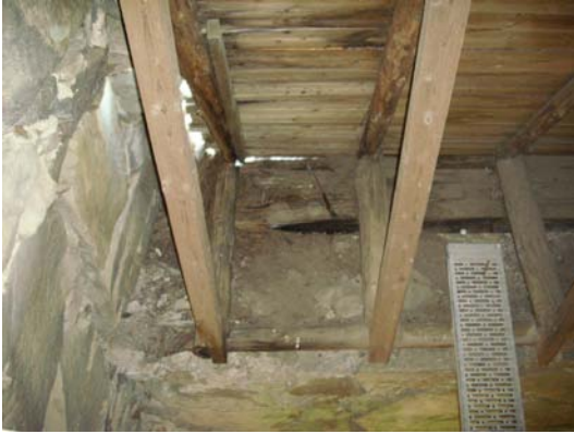
KUVA 5. Länsilappeen lahovaurioiset jalasorret vaativat toimenpiteitä.
