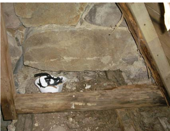
KUVA 3. Länsilappeen lahovaurioinen kápälä.
