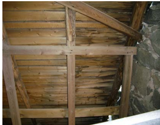
KUVA 2. Itälappeen vastaavat vahingot. Kuvassa on havaittavissa jiirin puuttuminen.
