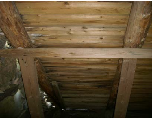
KUVA 1. Länsilappeen kosteudesta kärsineet rakenneosat, aluslaudoitus ja selkäpuu.
