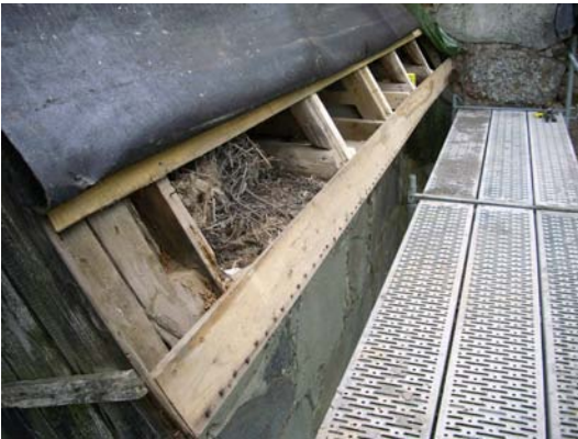
KUVA 11. Rakenteissa on runsaasti lintujen sinne kuljettamaa maatuvaa jätettä.
