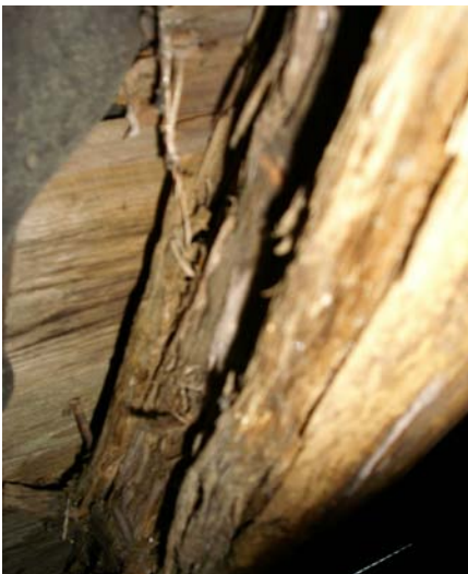
KUVA 7. Etelämuurin viereinen selkäpuu länsilappeella on menettänyt mekaanisen kestävyytensä.
