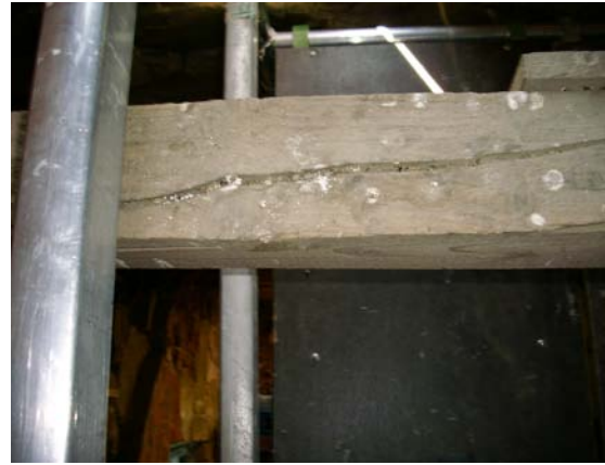
KUVA 10. Muissakin kitapuissa on halkeamia.
