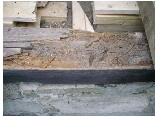
KUVA 12. Uloimman jalashirren kohdalla Ruskolaho ja hyönteisvauriot ovat mittavat.
