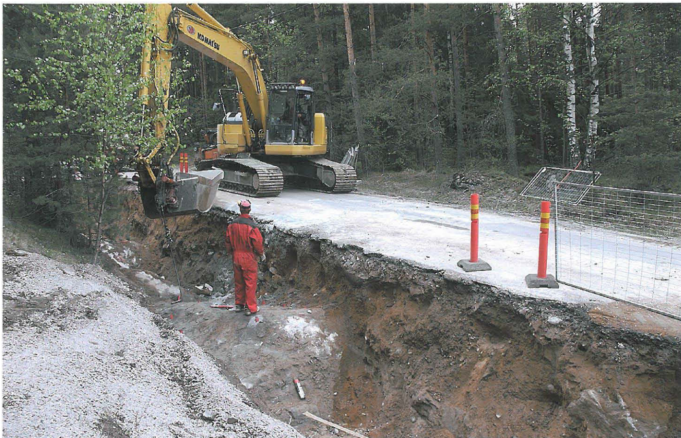
Kuva 5: Yleiskuva viemäriojasta ennen räjähdystä. Liesi sijaitsee profiilissa kuvassa olevan miehen oikealla puolella. Lounaasta.
