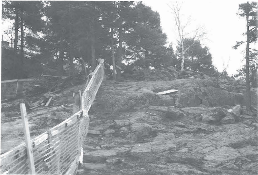
136167 SKRATTBERGET. RÖYKKÖ KALLION LAELLA. VAS RIVITALOTYÖMAAN AITA, JOICA ULOTTUU TILARAJAA PITÄEN MUINAISJÄÄNNÖKSEN REUNAA. LÄNSILUOTEESTA.
