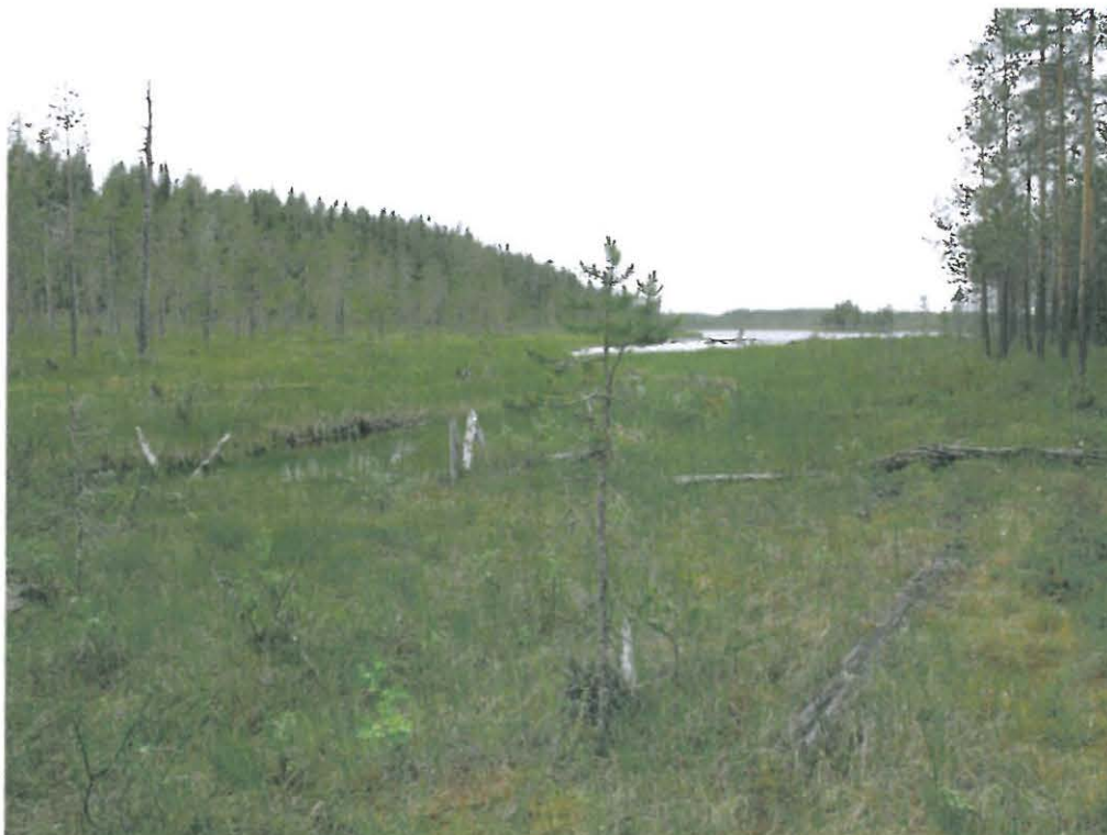
Alla: Närängänvaara Ellinlampi silta? (82771) ja Ellinlampi 2 silta (82772). Vanhempi silloista (82771) etualalla, taustalla häämöttää lammen eteläpäässä oleva uudempi silta, joka tosin on myös romahtamassa. Kuvattu kaakosta luoteeseen, 3.7.2009.
