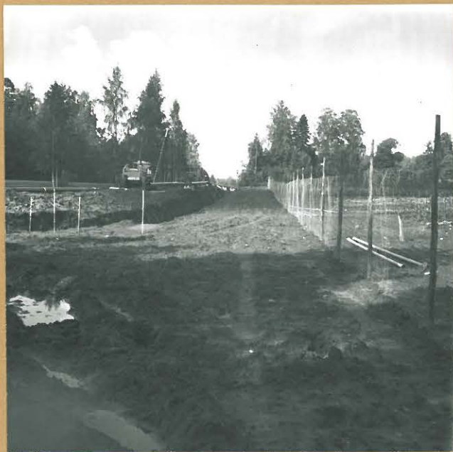
Kuva 18. Maakaasuputkikaivanto Barkholtin puutarhan luona, paalun 3700 kohdalla. Aidan vierestä kuvan oikeasta laidasta löytyi rautakautista keramiikkaa! SE. Neg. 65837
