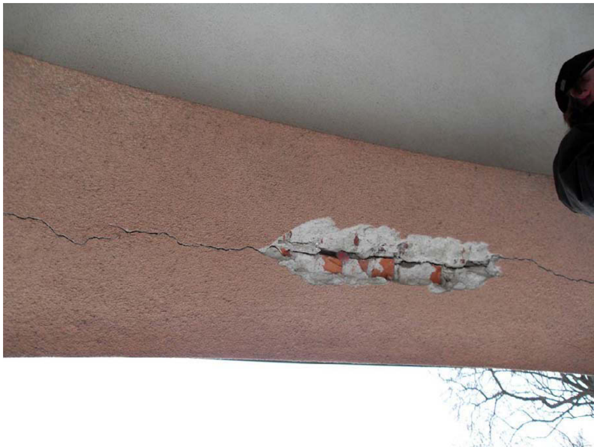
Vilpolan holvikaaren halkeamavaurio. Kuva Ilona Venetpalo maaliskuu 2010, MV.
