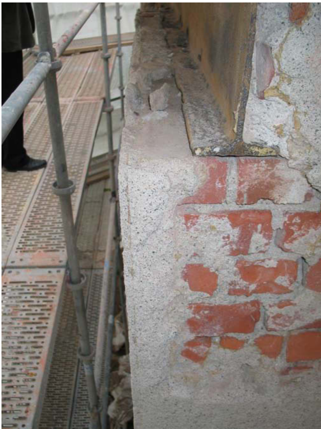
Vilpolan teräspalkki paljastettuna. MS 6.7.2010
