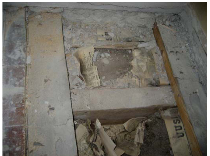
Lattian rakenneavaus. Ponttilaudan alla on käytetty aluspaperina Uuden Suomen sanomalehtipaperia syksyiltä 1940. Silloin korjattiin päärakennusta presidentin käyttöön. MS 22.4.2010
