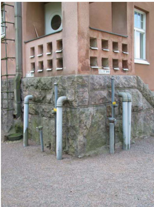
Pohjoisen pihatasanteen alle on rakennettu öljysäiliöt, joiden täyttö- ja muut putket muodostivat sekavan ryhmän , kuva 2009. MS 14.8.2009
