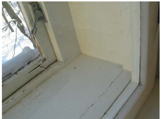
Ikkunanvaurioitunut ulkopuute, 2.kerros. MS18.2.2010
