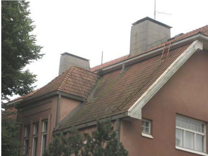
Vesikatto ennen korjausta. MS 2009
