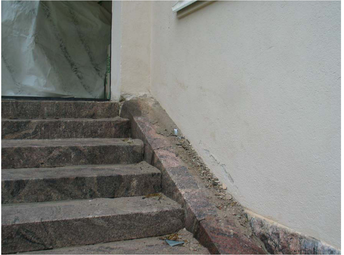
Vilpolan ulkoportaan viereinen uusi rappauspinta oli alttiina kastumiselle ja vaurioille. Tilalle suunniteltiin graniittijalkalista. Kuva on otettu ennen kuin muutos toteutui. MS 16.5.2011
