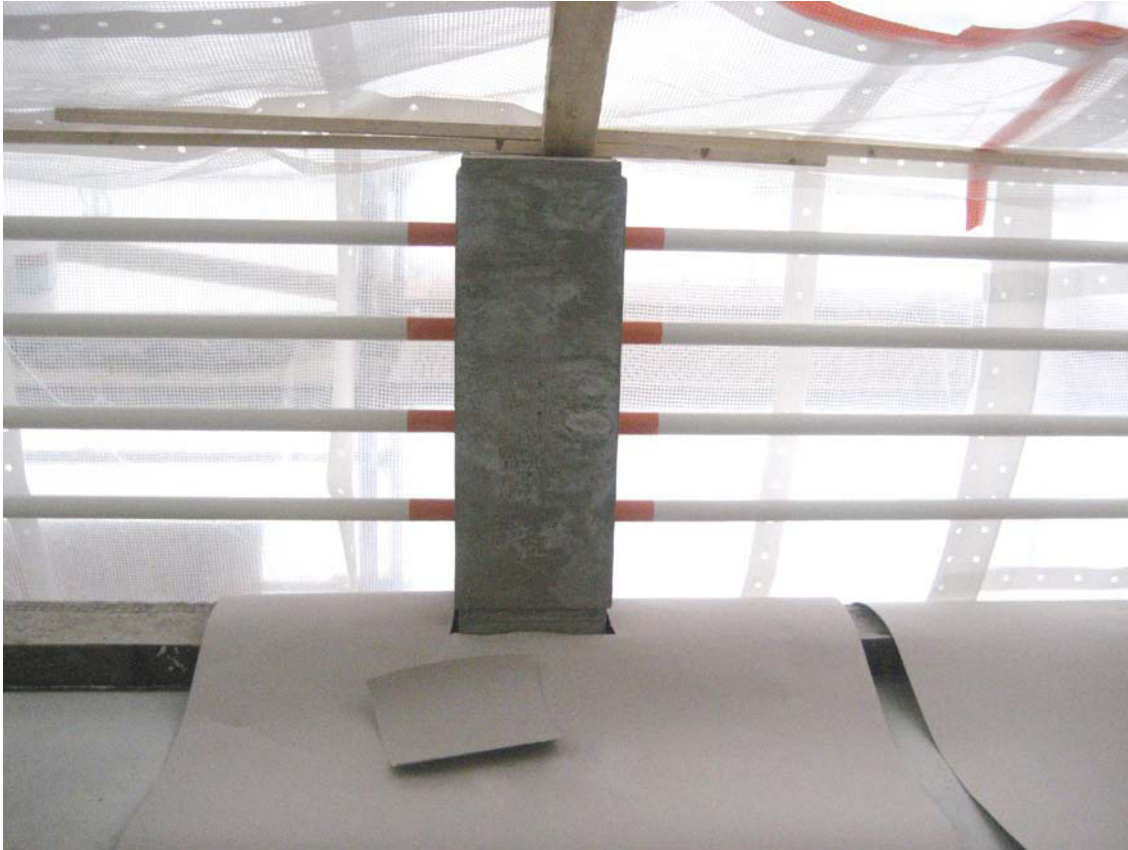
Parvekepilarit on valettu uudestaan rakennesuunnittelijan työnaikaisen ohjeen mukaan ja kaideputket on uusittu. MS 23.11.2010
