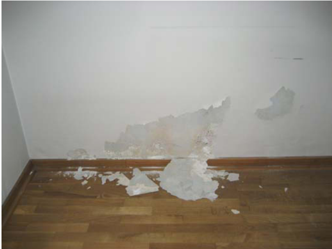
105 Seurusteluhuone. Irtoavia maalikerroksia. MS 3.6.2010
