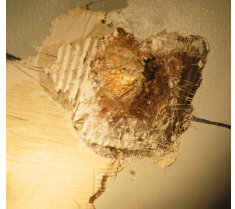
Pukeutumishuoneen kattolevynä on käytetty ns. Kokoliittia. MS 22.4.2010
