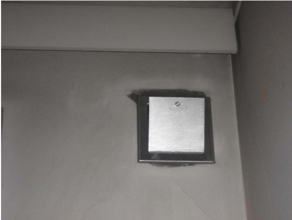
Uusi raitisilmaventtiili asennettuna ulkoseinään. MS 23.11.2010
