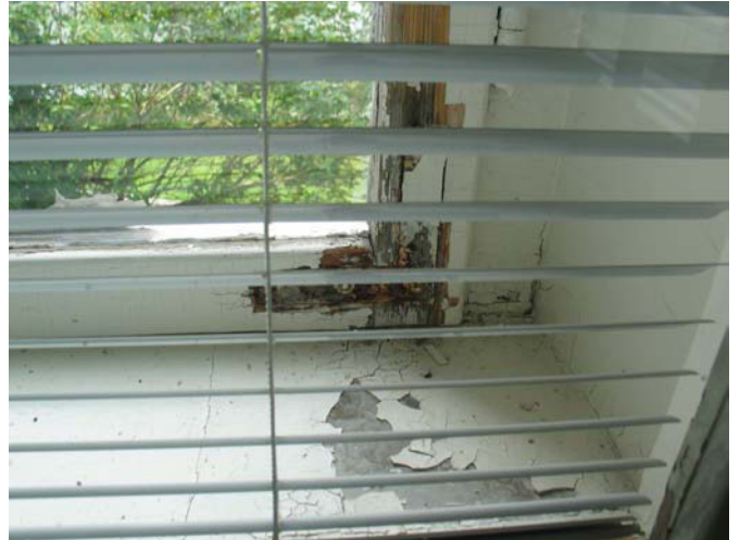
Ikkunanvaurioitunut ulkopuute, 1.kerros. MS14.8.2010
