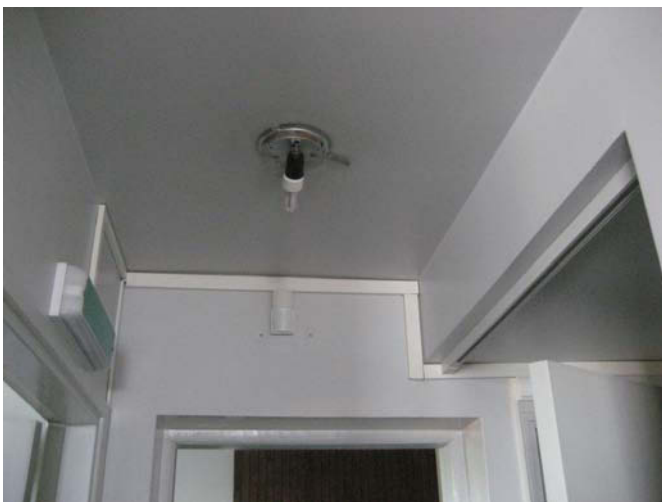
Laitteiden ja johtojen pinta-asennuksia, 2.kerros. MS 3.6.2010
