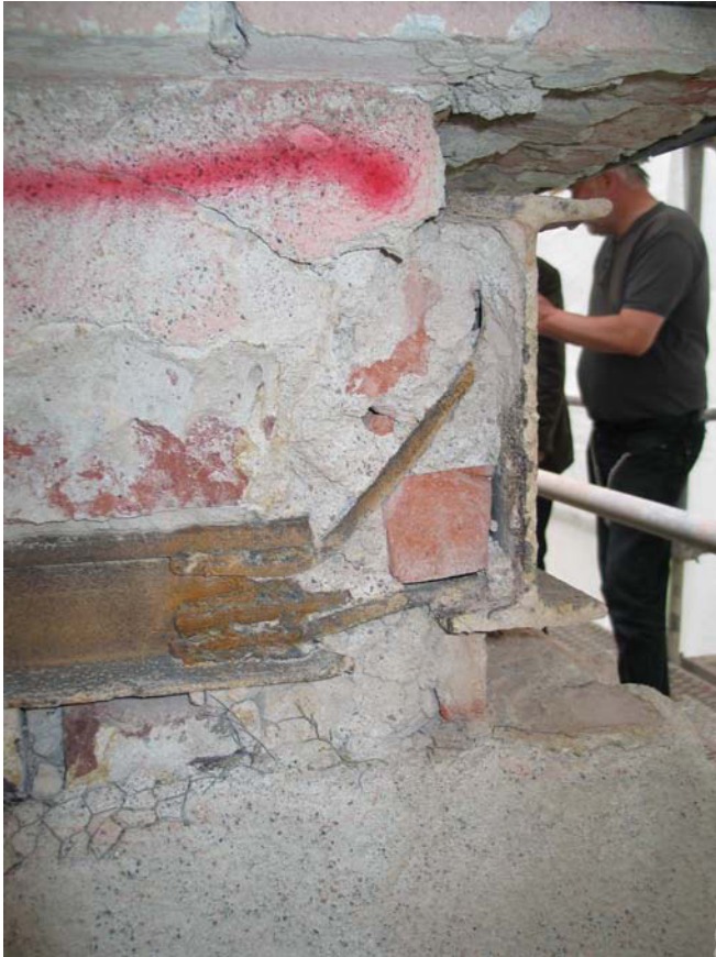
Vilpolan teräspalkki paljastettuna. MS 6.7.2010
