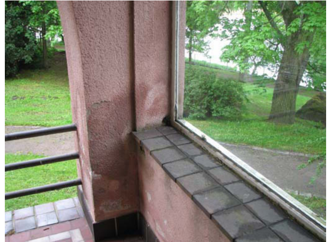
Vilpolan yksityiskohta ennen korjausta 20.6.2010. R. Laeslehto
