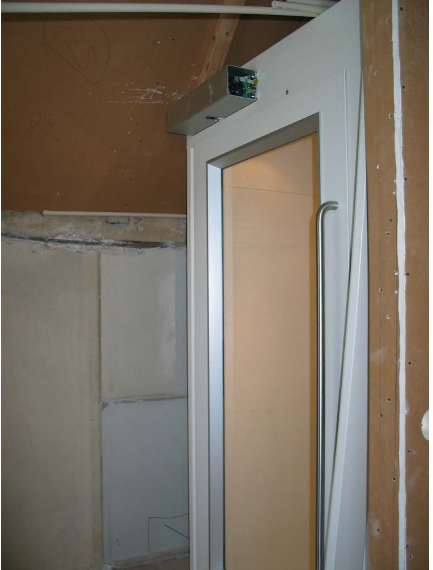
Hissi on asennettu tiukasti mitoitettuun tilaan 2. kerroksen entiseen pukeutumishuoneeseen. Hissiin rajautuvien rakenteiden teko on meneillään. MS 20.6.2011
