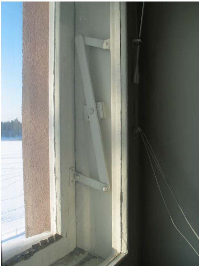
Ikkunan kytketty avausmekanismi, 2.kerros. MS18.2.2010
