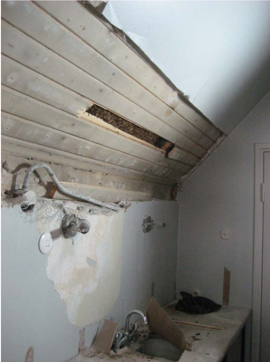
208 Pukeutumishuoneen sisäkaton rakenneavaus. Uudempien kerrosten alta löytyi jonka alle on jätetty 1900-luvun alkuvaiheelle tyypillistä höylättyä paneelia MS 4.5.2010.
