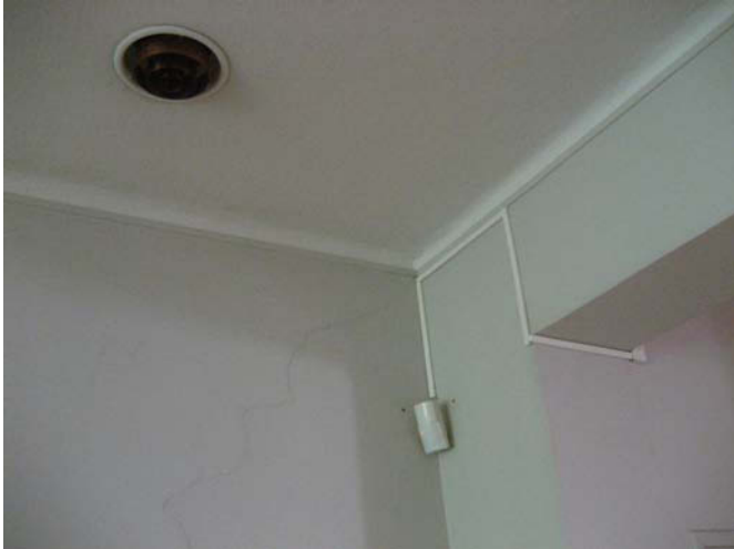
Valvontalaite, pinta-asennus, 2.kerros. MS 3.6.2010
