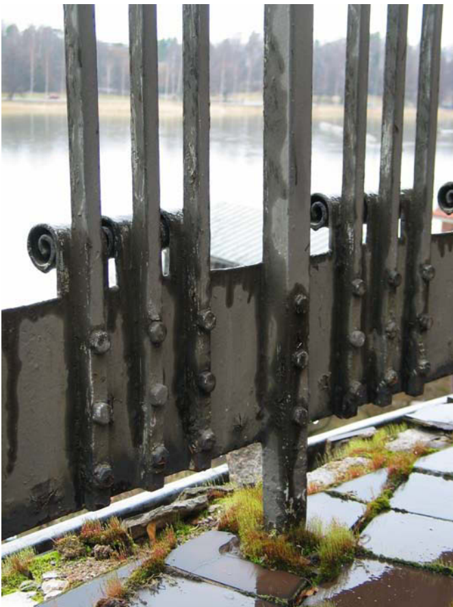
Tilanne ennen korjausta.
