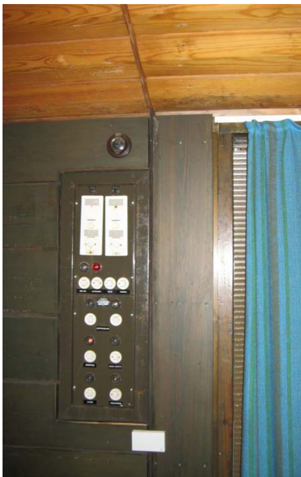
3 Pohjoisseinään upotettu mittarikeskus.
