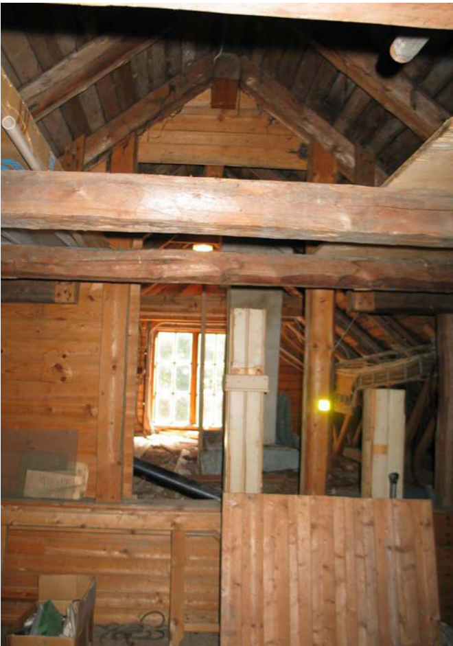
Kattotuoleja on tuettu. Alun perin vesikatteena oli kevyempi huopakate.
