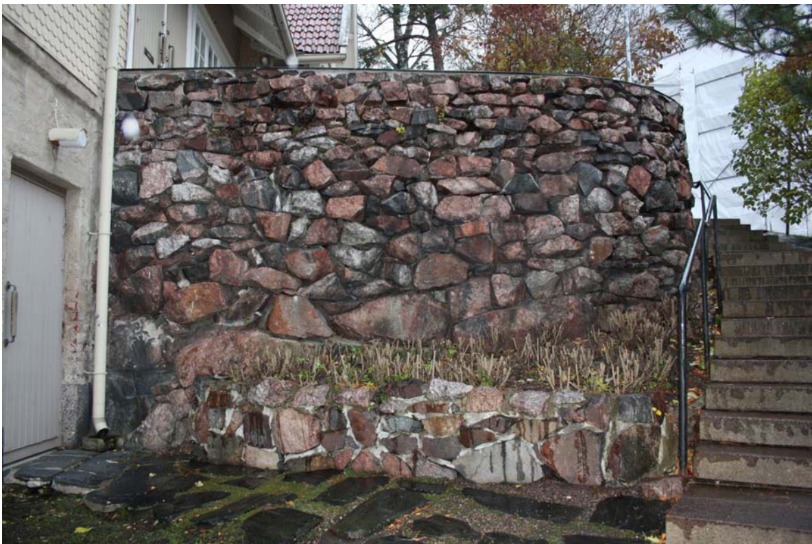
Pihaterassin tukimuri 1900-luvun alusta. Vuonna 1956 rakennetut maastoportaat on myöhemmin korjattu ja uusittu.
