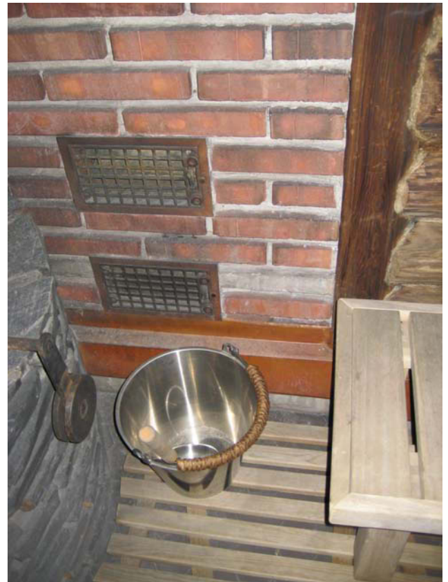
Kiukaan hormi ja ilmventtiilit.
