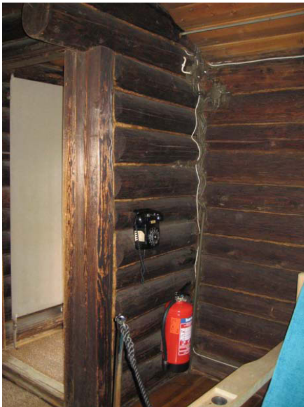
3 Puhelinkoje ja johtojen pinta-asennuksia tuulikaapin pyörö-hirsiseinässä.
