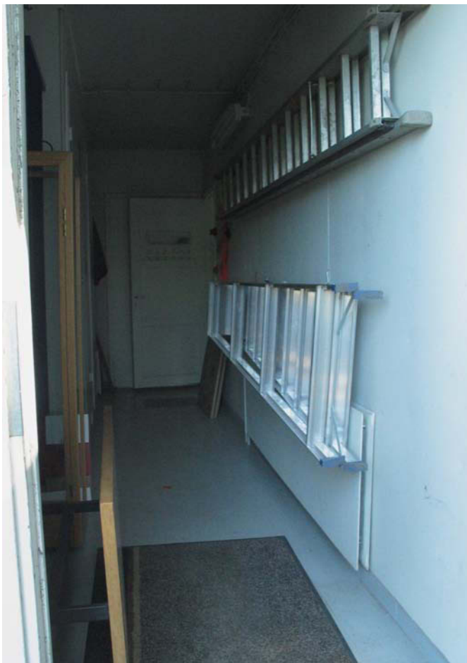
Entisen pyykinkuivaustilan sivulle on rakennettu sähköpääkeskus 1970-luvulla ja lisää keskuksia 1990-luvulla.
