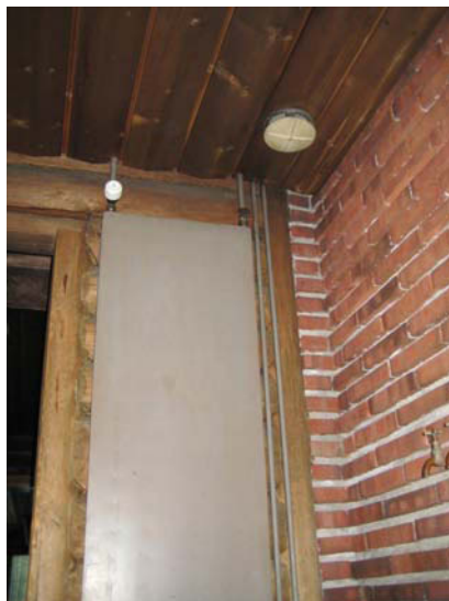
Oikealla ylhäällä muovinen poistoilmaventtiili.
