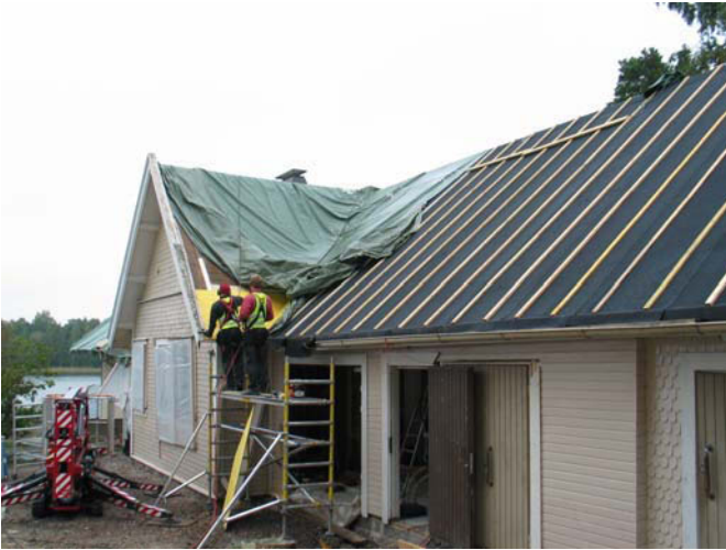
Uusi aluskate ja alempi rimakerros. Räystään yläpuolella oleva vaakalista on vanhaa rakennetta. MS 21.9.2011
