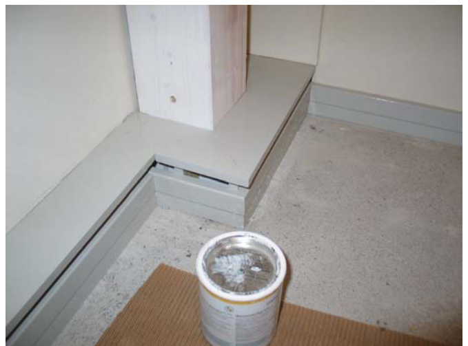
T110. Alapohjan lämmityksen tuuletusta varten suunniteltu jalkalistakotelo. MS 22.12.2011
