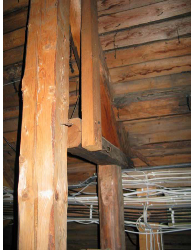
Ullakon itäosa. Sähköjohtoryhmä. MS 29.10.2009
