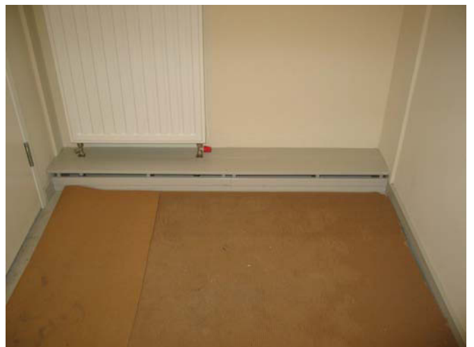
T106 Välikö. Alapohjan lämmityksen tuuletusta varten suunniteltu jalkalistakotelo. MS 22.12.2011
