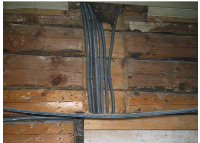
Hirsiseinään roilottuja sähköjohtoja autovajan puoleiseen varastoon. MS 23.2.2011
