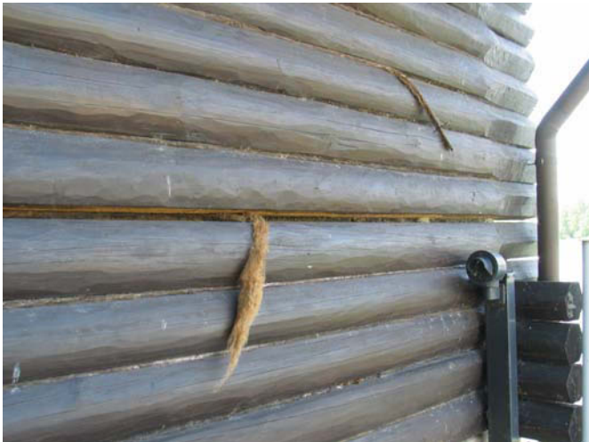
Hirsipaneeliseinän vaurio. Pohjoissivu. MS 13.6.2009.
