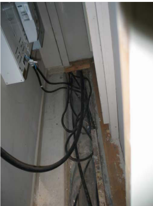
Sähköpääkeskus ja ryhmäkeskukset, käytävä. MS 29.10.2009.
