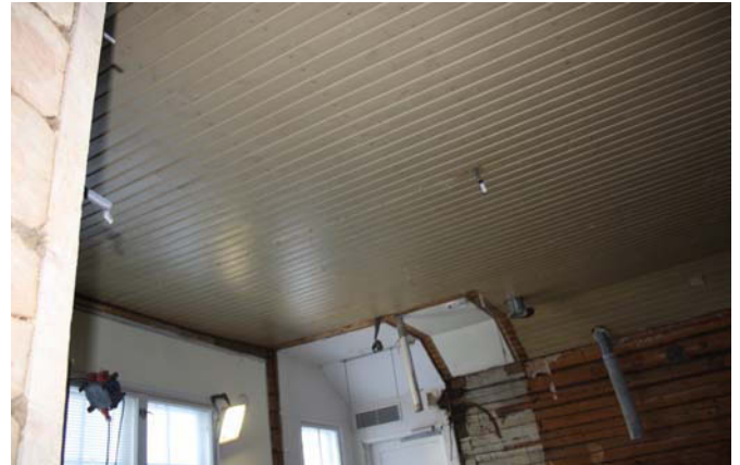
Levytyksen alta paljastunut lautapaneelikatto MS 2.3.2011
