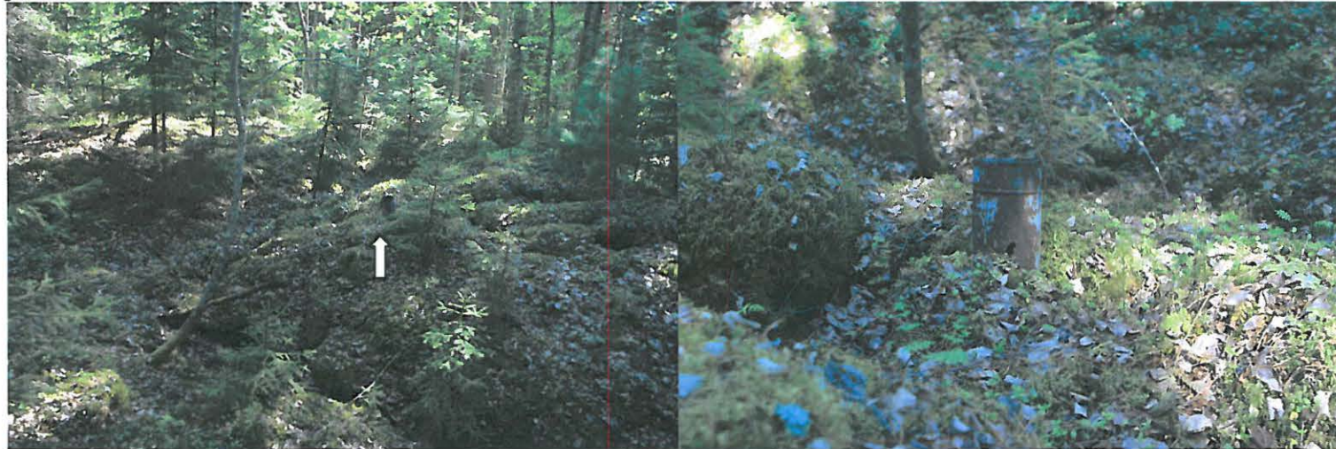
Vasemmalla kuva suojan päältä sisään romahtaneesta suojasta. Nuoli osoittaa oikealla olevan yksityiskohtakuvan putken sijaintia.
