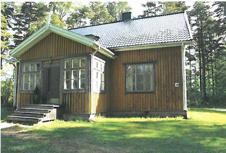
Rakennuksen julkisivun maali on rapistunut.
