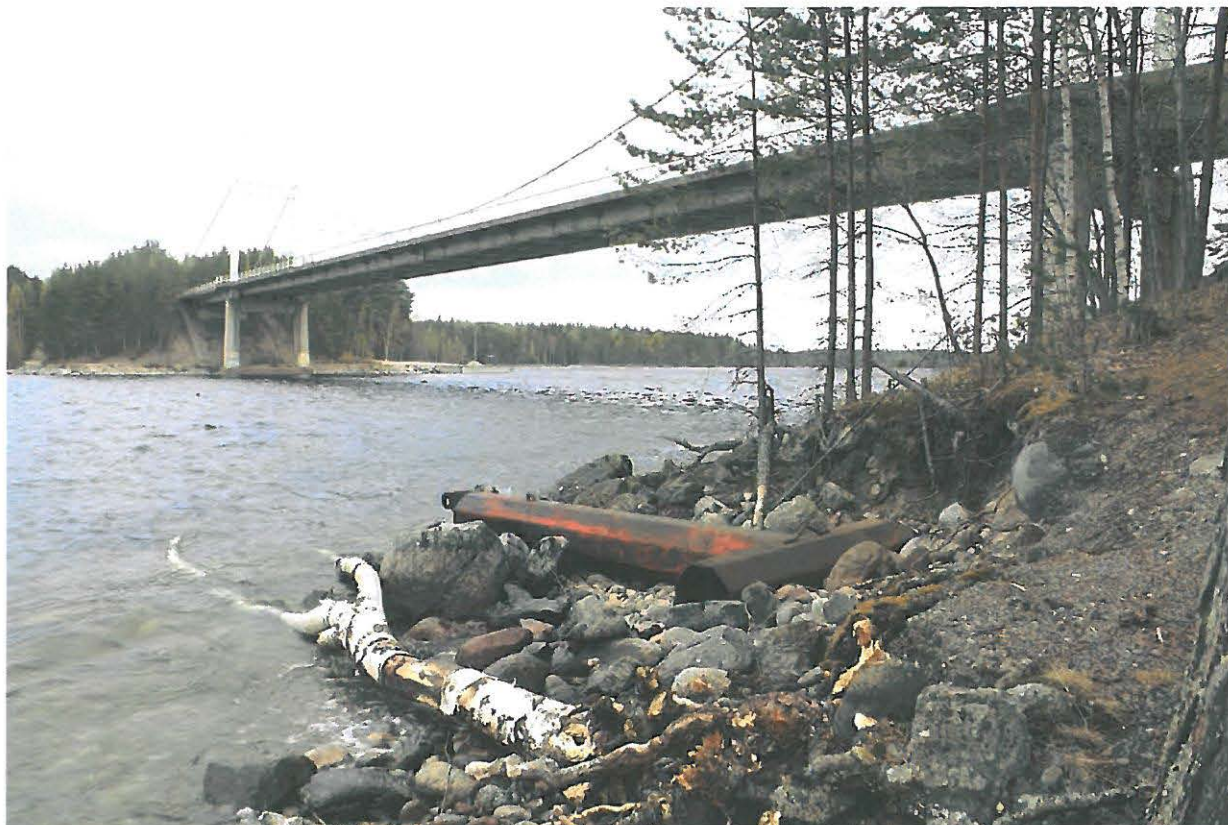
DSC01509. Pulkkilanharju Karinsalmi, lossinpaikka. Lossin vaijerin kiinnitysteline, taustalla Käkisalmen silta, lounaasta. 14.5.2009.
