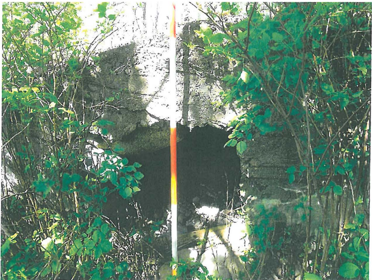
DSCN0353.JPG Pispan koulu. Rakenne 1. Aukko SW-seinässä. Lounaasta. 12.5.2008, Vadim Adel.
