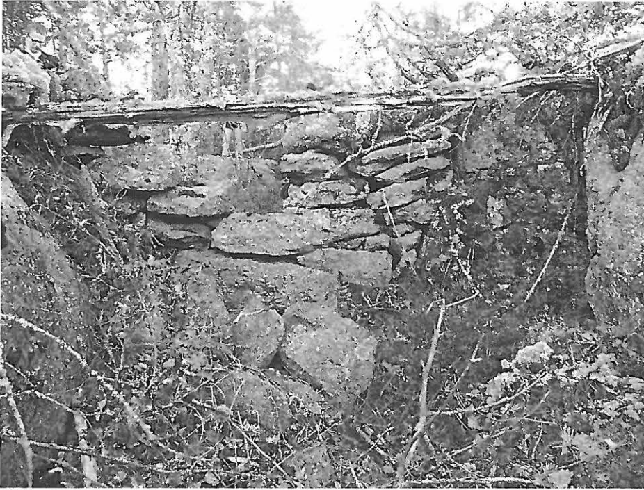
Kylmämuuratun huoneen takaseinä on keskeltä osin romahtanut. Kuva kohti SE. Kuva Tarja Knuutinen.
