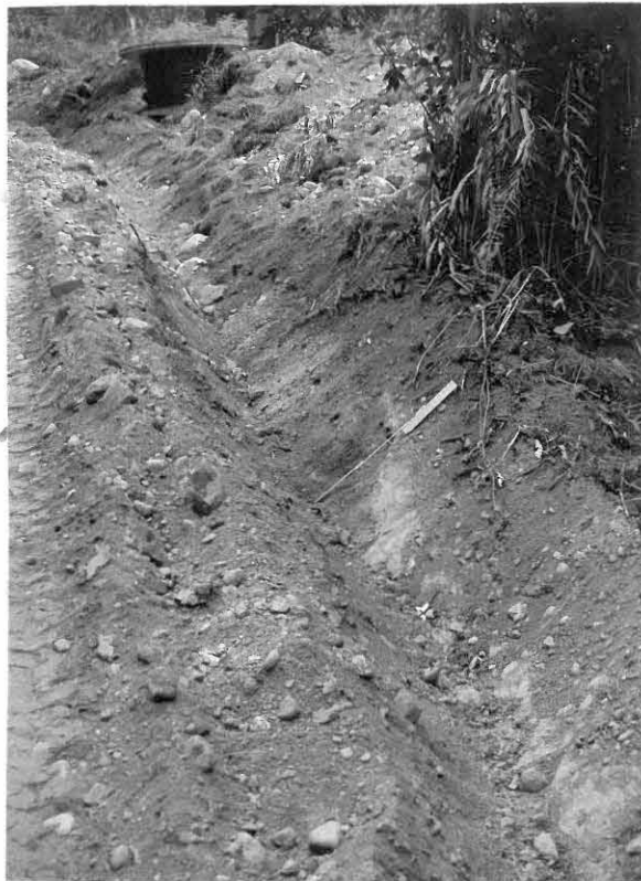
113 765 Ruutu 72/8 lähikuva; kohta josta koilliseen savipengerrystä on alettu rakentaa. Savipengerrys näkyy profiilissa vaaleampana läikkänä. Koillisesta / idästä..
