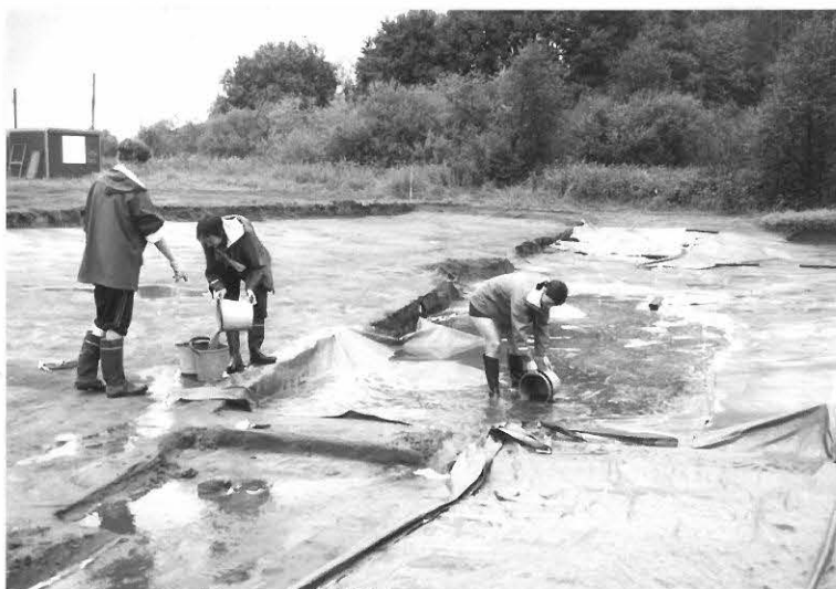
Neg.nro 125691 Työkuva. Karilantie, sadekuurotuhoja paikkaillaan. Kuvassa Ninni Närväinen, Marjukka Bastamow ja Katja Vuoristo. Kaakosta. Kuva E. Mikkola
