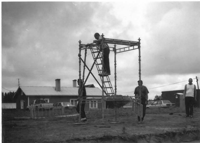
Neg.nro 125696 Työkuva. Valokuvaustornia pystyttämässä Ismo Mattola, Veini Kuuva, Juha Nykänen ja Esa Mikkola. Kaakosta. Kuva K. Vuoristo
