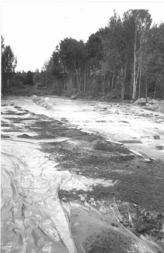
Neg.nro 125910 Karilantien oikaisulinjan länsipuoli muovein peitettynä ja pohjoisosa pohjaan kaivettuna. Lounaasta. Kuva E. Mikkola
