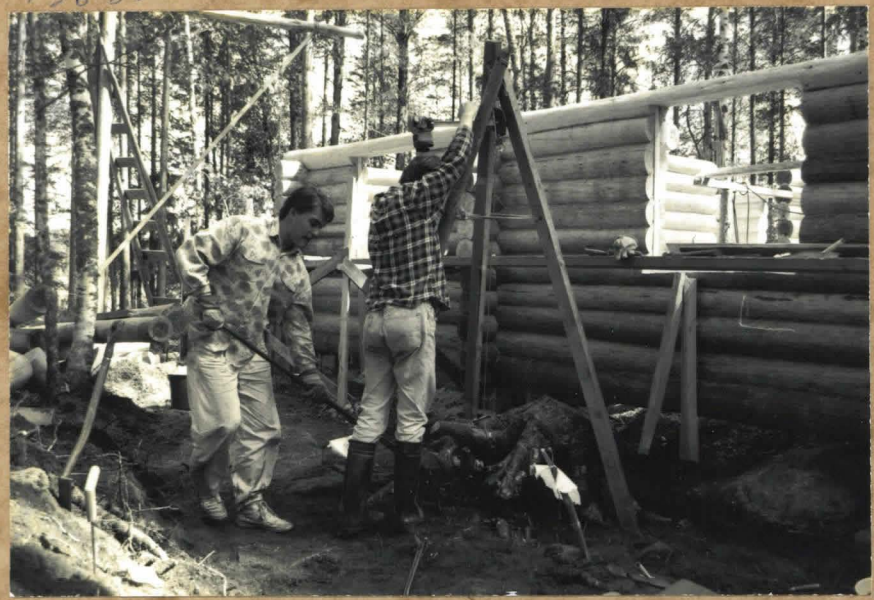
LÄNSISEINUSTALLA OLEVA ISO KANTO (RUUDUT A-B5) POISTETAAN. SEN ALLA OLI LIEHENPÄÄNNÖS WSW: 67A
