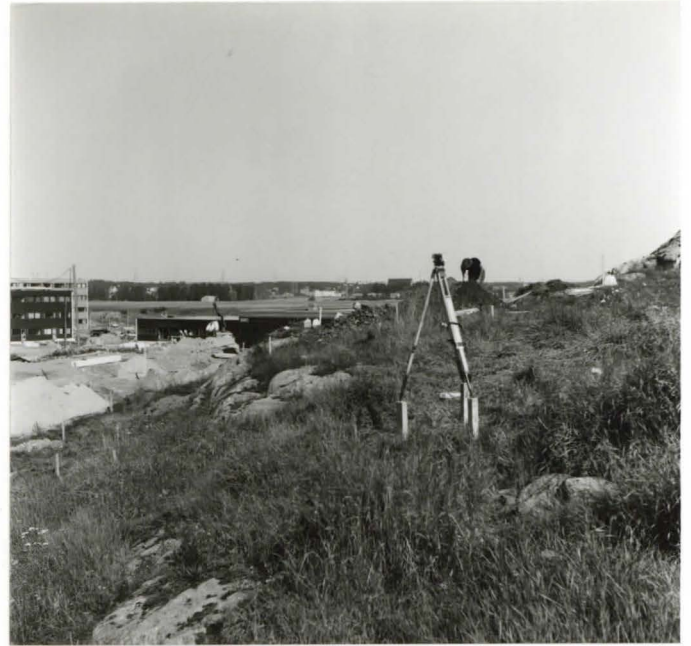
2. Kaivausalue I ja koeoja (vasemmalla alareunassa) etelästä. Edessä vaaituskojeen paikka. (negat. TYA 1284)
