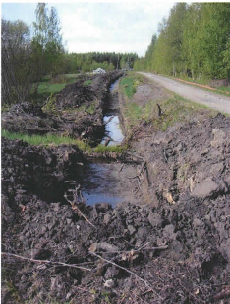
Kuva 9. Pohjoinen valvonta-alue (Osa-alue 2) kaivettuna. Oikealla Hörssintie. Valvonta-alueella oli oja, jonka läheisyydessä vesi peitti kaivannon. Kuvattu koillisesta. Kuvaaja Kalle Luoto. Raportin digitaalikuva 011.jpg.
