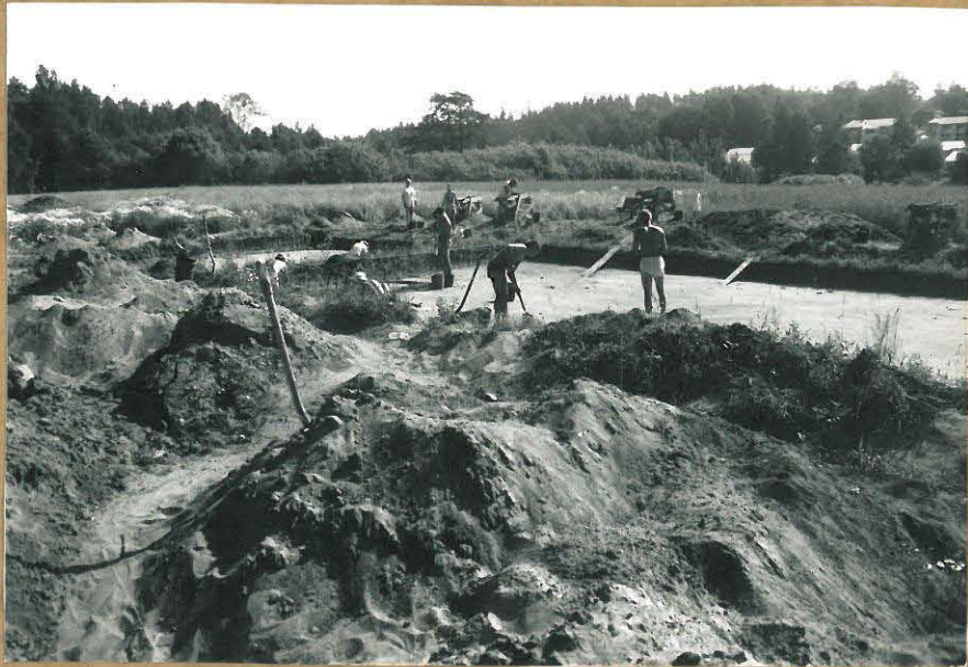
K 1. Yleis- ja työkuva, alueita A6 ja A7 100390 kaivetaan 30° helteestä, kohti NE
