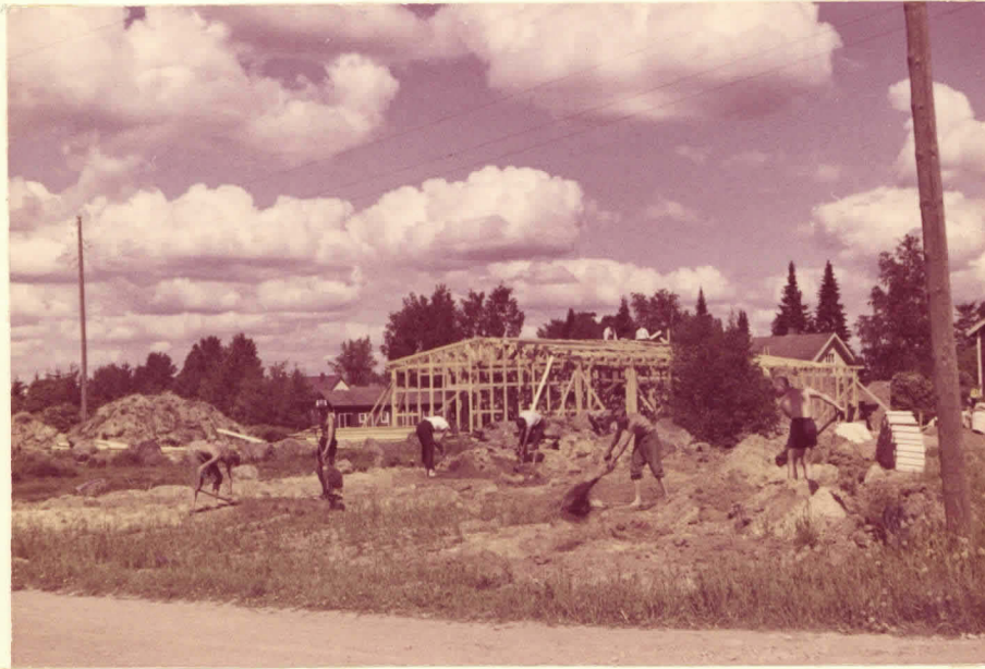
1. TARKASTUSKAIVAUS KÄYNNISSÄ KUMLANDERIN TONTILLA. TAUSTALLA ON KUMLANDERIN RAKENTEILLA OLEVA OMAKOTITALO. KUVA ON OTETTU ETELÄLOUNAASTA.
