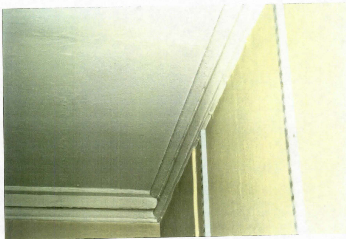
KATTOLISTA VÄLIOSAN HUONEESSA 211, ALASLASKETTU KATTO PEITTÄÄ OSAN LISTAA
