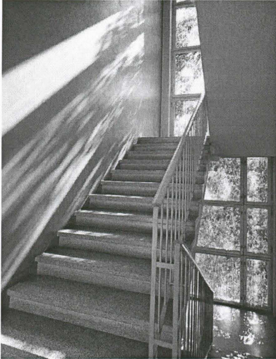
Luokkasiiven päädyn porras 08 vuonna 2002: mosaiikkibetonია, lakattu koivuinen käsijohde, Lindroosien värisuunnitelman mukaisesti vihreäksi maalattu sivuseinä (kuva: Heikki Rautio).
