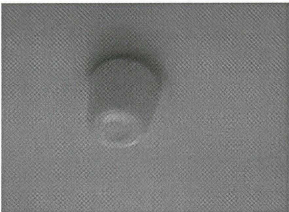
Sylinterimäinen, pohjasta kupera opaailiasinen kattovalaisin, "Sylinteri B", Orno? (porrashuone 106).
