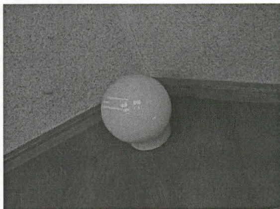
Pallomainen lasikantainen seinävalaisin, Orno (kellarikerroksen tuulikaappi K39).
