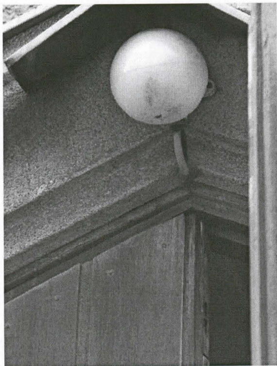
Kellarikerroksen entisen kahvilan sisäänkäynnin opaalipallovalaisin.
