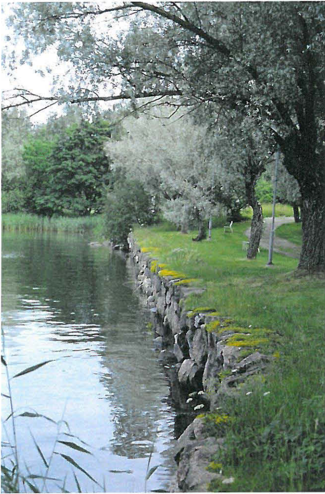
Kuva 159. Sairaalan pohjoispuolella oleva ranta on tuettu muurirakentein. Sen päällä kukkii keltaisena keltamaksaruoho ( Sedum acre ). Hopeasalavakujanne ( Salix 'Sibirica' ) on istutettu 1930-luvulla.
