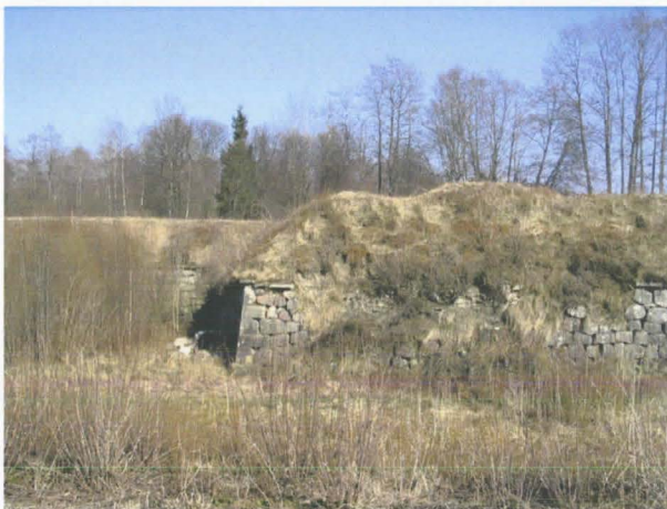
Muurit ovat paikoin sortuneet.
