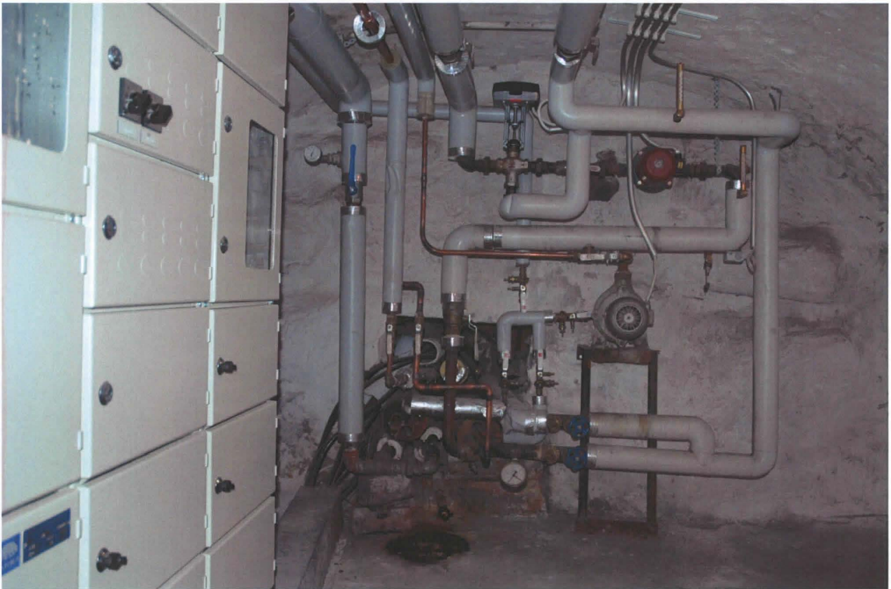
Kellarikerroksessa sijaitsevat öljykattila ja koteloitu sähköpääkeskus. Alimmaisessa kuvassa putkikanaalin liitokset.
