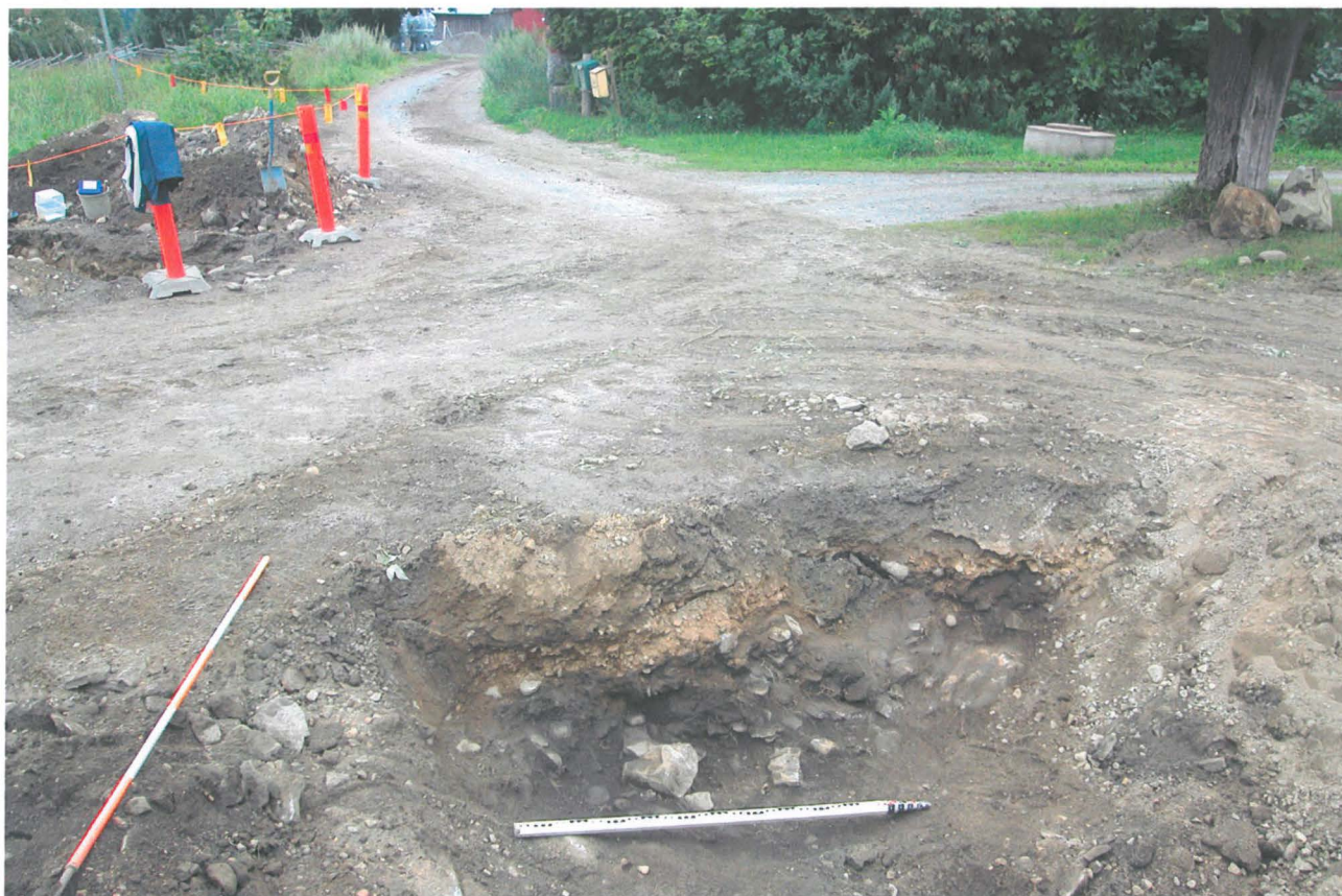
DSCN0170.JPG Kohde 3. Nokimaata ja kiveystä kaivannon NW-reunassa/-profiilissa. Linjakeppi vasemmalla makaa samalla linjalla navetan SW-seinän kanssa. SE
