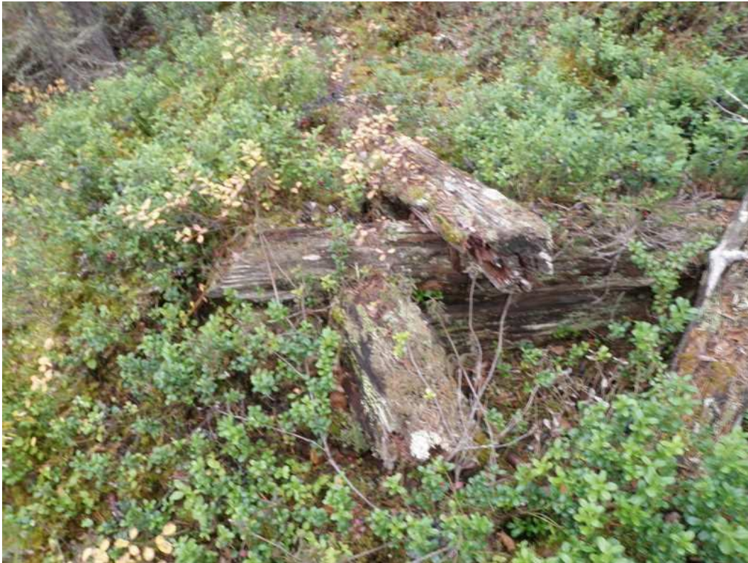
Kämpän lahonneita salvosrakennelmia.
