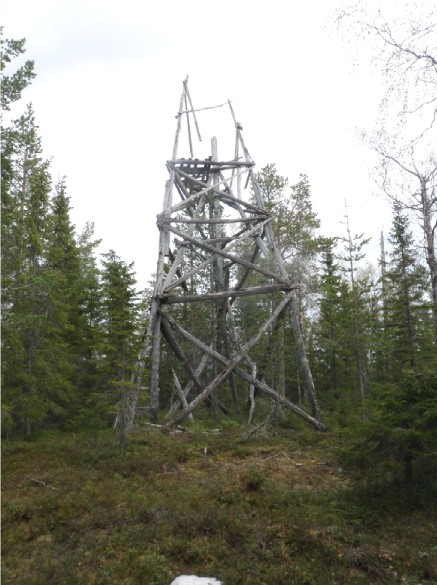
Torni on latvasta romahtanut.
